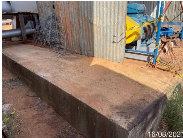
Foto 7.390: Ausência de camada regularizadora sobre a base de suporte dos silos do Sistema de Cal da imagem: 16/08/2021)
