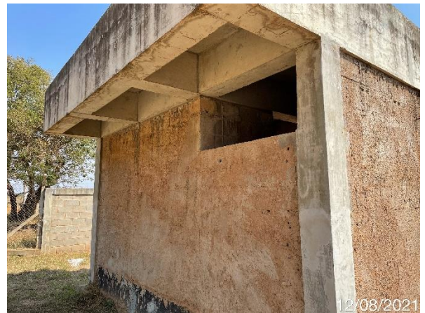
Foto 7.381: Alvenaria danificada (Data da imagem: 12/08/2021)
