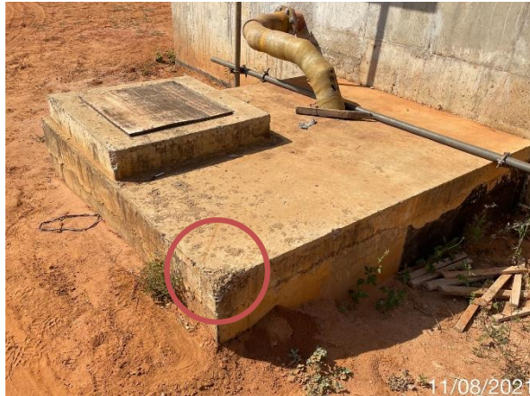
Foto 7.91: Arestas da laje da Caixa de Óleos e Graxas danificadas (Data da imagem: 11/08/2021)
