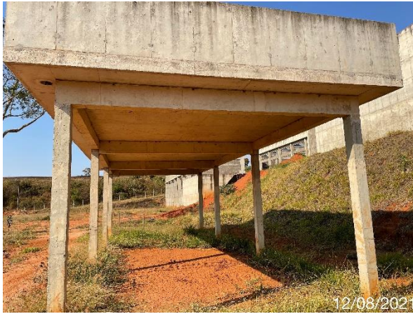
Foto 7.466: Aparência externa da subestação SE-09 (Data da imagem: 12/08/2021)
