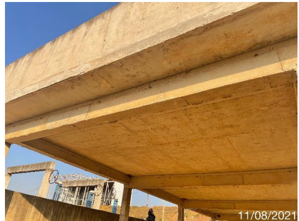
Foto 7.449: Presença de núcleos perdidos (Data da imagem: 11/08/2021)
