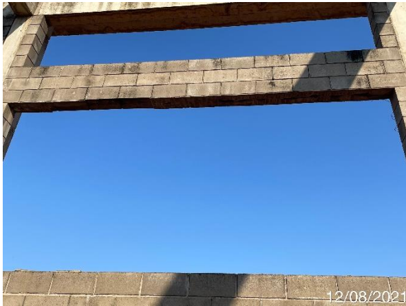
Foto 7.302: Ausência de instalação das esquadrias (Data da imagem: 12/08/2021)
