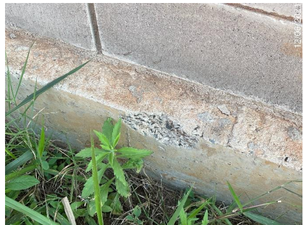
Foto 7.349: Estrutura danificada (Data da imagem: 12/08/2021)
