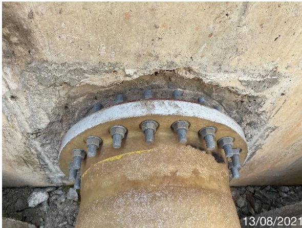
Foto 7.215: Parade com cobertura da armadura reduzido (Data da imagem: 13/08/2021)
