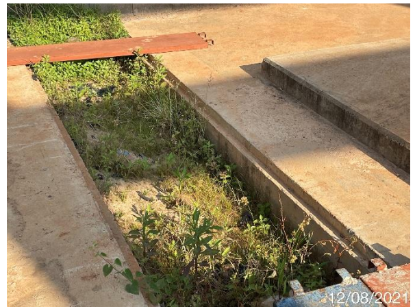
Foto 7.305: Canaletas soterradas e com presença de vegetação (Data da imagem: 12/08/2021)
