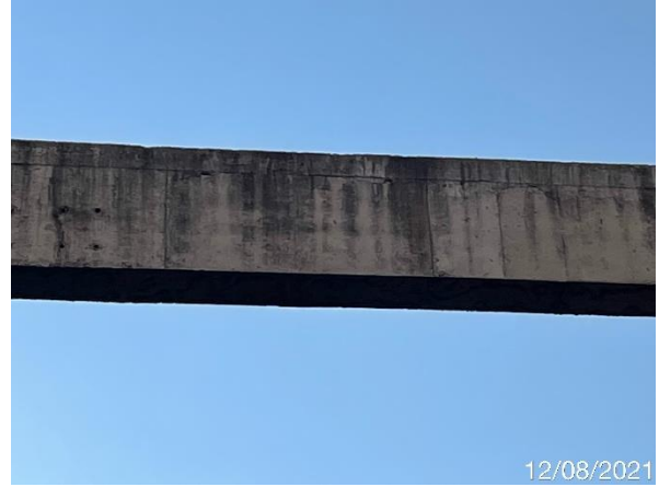
Foto 7.315: Superfície de concreto irregular, com presença de fissuras e marcas de forma no concreto (Data da imagem: 12/08/2021)
