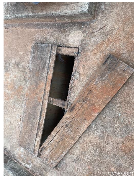
Foto 7.307: Ausência de instalação das tampas (Data da imagem: 12/08/2021)
