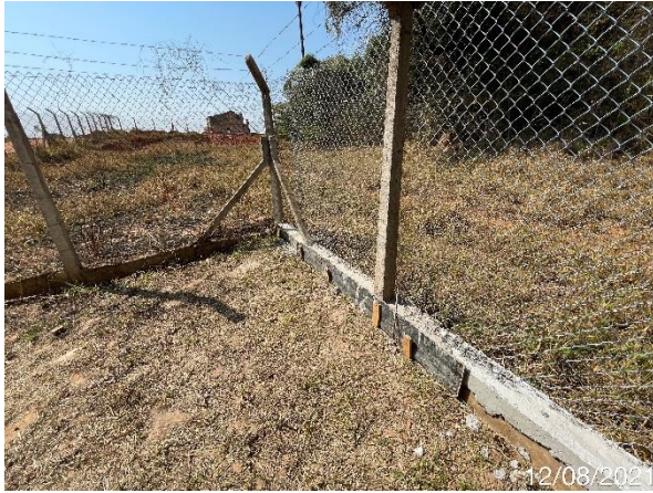
Foto 7.5: Presença de formas nas bases do mourão de concreto (Data da imagem: 12/08/2021)
