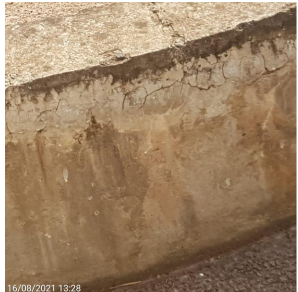
Foto 7.180: Irregularidade na superfície do concreto, com presença de fissuras e trincas (Data da imagem: 16/08/2021)
