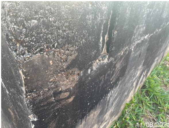
Foto 7.25: Espaços vazios detectados ao desformar a estrutura de concreto armado (Bicheiras) (Data da imagem: 11/08/2021)
