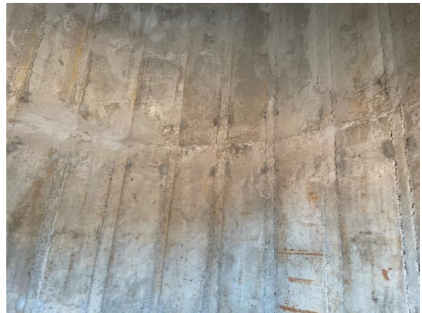
Foto 7.397: Marcas de formas no concreto (execução com forma inadequada) e fissuras (Data da imagem: 11/08/2021)
