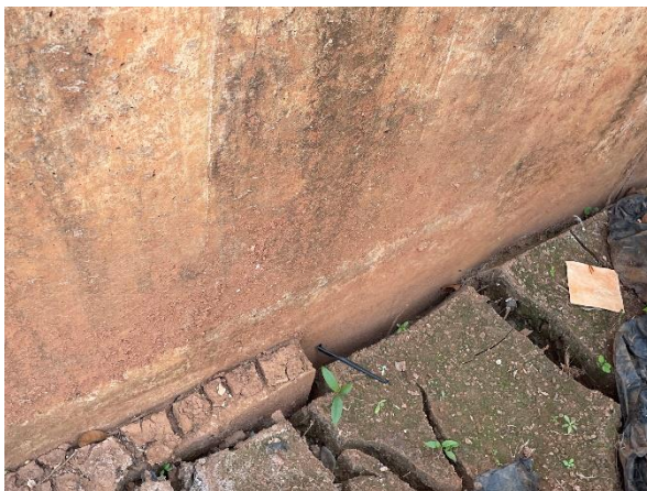
Foto 7.67: Ausência de Impermeabilização betuminosa. (Data da imagem: 11/08/2021)
