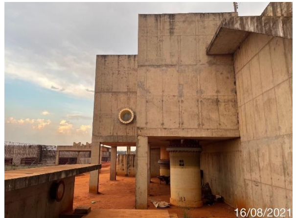
Foto 7.122: Superfície de concreto irregular, marcas das formas e vazios de concretagem (Data da imagem: 16/08/2021)
