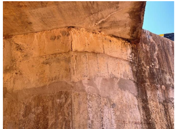
Foto 7.66: Superfície do concreto irregular e marcas de forma (Data da imagem: 11/08/2021)
