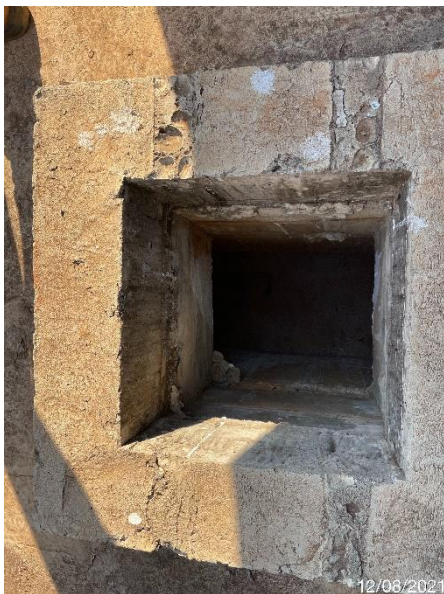
Foto 7.306: Ausência de instalação das tampas (Data da imagem: 12/08/2021)
