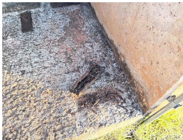
Foto 7.46: Presença de taliscas de madeira incorporada na laje, bem como superfície de concreto irregular (Data da imagem: 11/08/2021)
