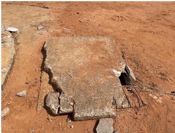
Foto 7.400: Tampa da caixa de inspeção danificada (Data da imagem: 11/08/2021)
