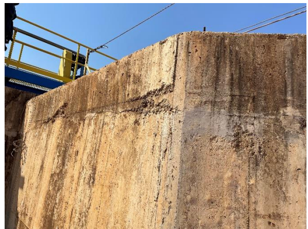
Foto 7.74: Superfície de concreto irregular (Data da imagem: 11/08/2021)
