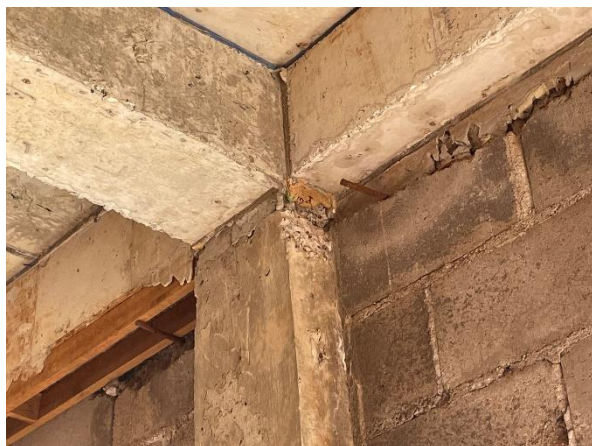
Foto 7.442: Superfície de concreto irregular, com fissuras, trincas e vazios de concretagem e presença de formas de madeira (Data da imagem: 11/08/2021)
