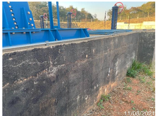
Foto 7.22: Irregularidade na superfície do concreto e com presença de fissuras (Data da imagem: 11/08/2021)
