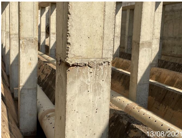
Foto 7.217: Superfície de concreto irregular com presença de vazios de concretagem e bolhas (Data da imagem: 13/08/2021)
