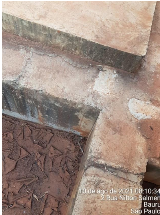
Foto 7.111: Superfície de concreto irregular, com fissuras (Data da imagem: 10/08/2021)
