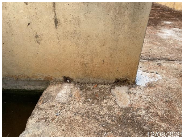
Foto 7.266: Estrutura de concreto danificada (Data da imagem: 12/08/2021)
