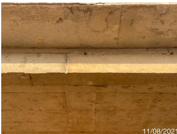
Foto 7.450: Presença de núcleos perdidos, marcas de formas no concreto e fissuras (Data da imagem: 11/08/2021)
