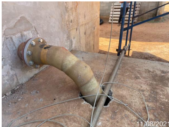
Foto 7.97: Ausência de acabamento na entrada da tubulação de Ø 150 mm (Data da imagem: 11/08/2021)
