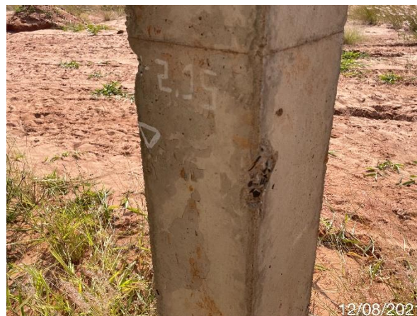
Foto 7.473: Estrutura danificada (Data da imagem: 12/08/2021)
