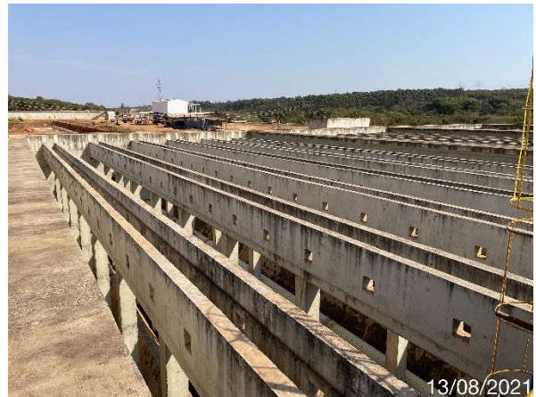
Foto 7.206: Aparência interna do Decantador Lamelar 3 (Data da imagem: 13/08/2021)
