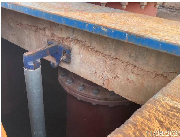
Foto 7.43: Superfície de concreto irregular e com presença de junta fria. (Data da imagem: 11/08/2021)
