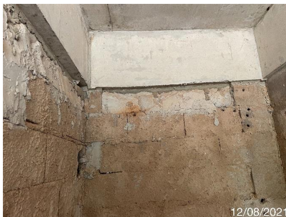
Foto 7.388: : Alvenaria com blocos danificados (Data da imagem: 12/08/2021)
