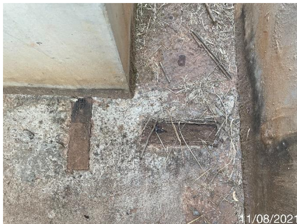
Foto 7.31: Presença de taliscas de madeira na laje, bem como superfície de concreto irregular (Data da imagem: 11/08/2021)
