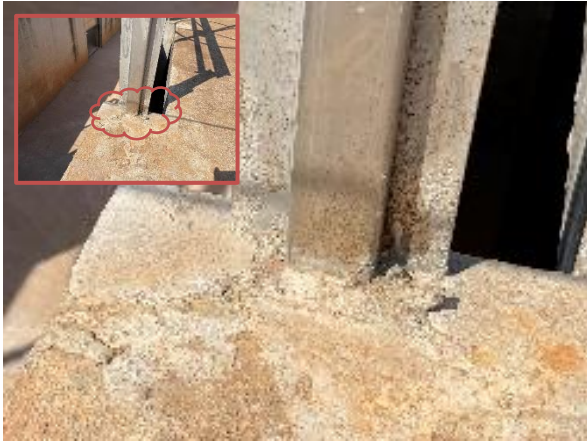
Foto 7.85: Presença de fissuras na instalação das comportas (Data da imagem: 11/08/2021)
