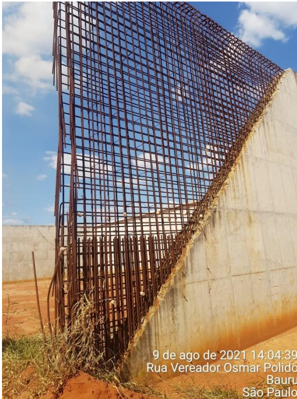
Foto 7.151: Parede inacabada, com ferragens expostas e sem proteção adequada (Data da imagem: 09/08/2021)
