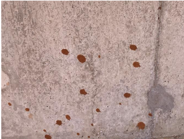
Foto 7.63: Presença de fissuras no concreto (Data da imagem: 11/08/2021)
