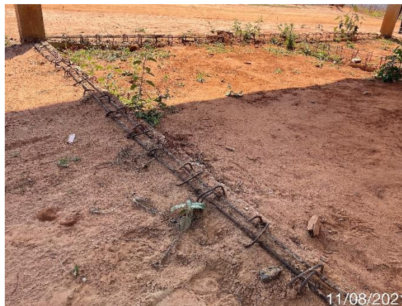
Foto 7.453: Ferragem da viga baldrame exposta sem proteção e danificada (Data da imagem: 11/08/2021)
