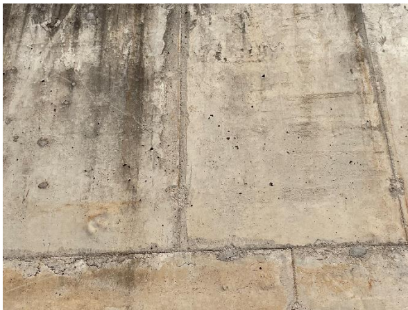
Foto 7.57: Marcas de formas na estrutura de concreto aparente e presença de bolhas de ar de concretagem (Data da imagem: 11/08/2021)
