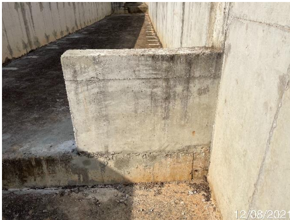
Foto 7.276: Superfície de concreto irregular (Data da imagem: 12/08/2021)
