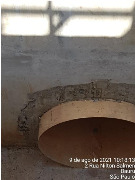
Foto 7.79: Trincas no concreto e superfície do concreto irregular (Data da imagem: 09/08/2021)
