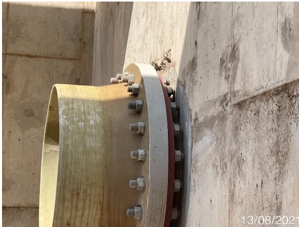
Foto 7.233: Cobrimento da armadura da parede reduzido (Data da imagem: 13/08/2021)
