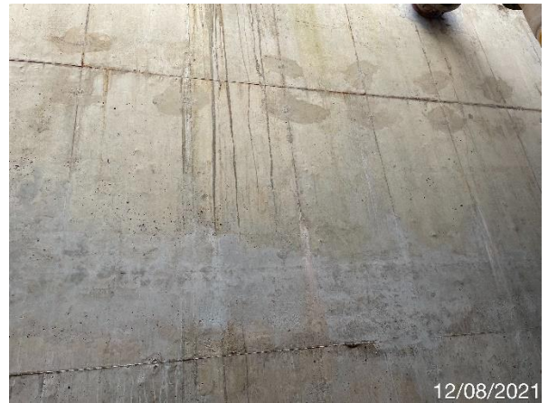
Foto 7.194: Superfície do concreto irregular, bolhas e com presença de vazios de concretagem (Data da imagem: 12/08/2021)
