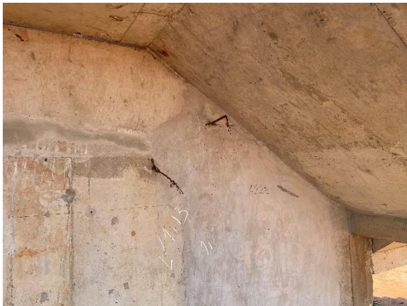
Foto 7.71: Superfície do concreto danificada com marcas de formas e ferragem exposta (Data da imagem: 11/08/2021)
