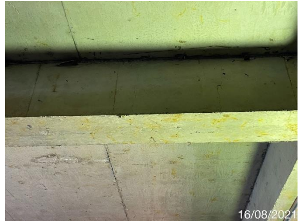
Foto 7.110: Marcas de formas na estrutura de concreto aparente e superfícies irregulares com trincas e fissuras (Data da imagem: 16/08/2021)
