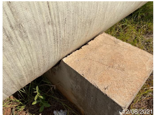
Foto 7.289: Estrutura do berço de apoio da tubulação danificada e com fissuras (Data da imagem: 12/08/2021)
