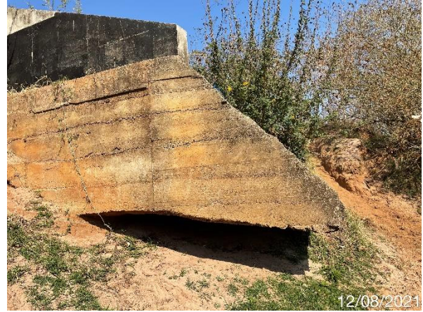
Foto 7.281: Estrutura do dissipador em balanço (Data da imagem: 12/08/2021)
