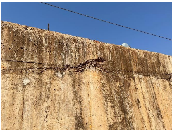
Foto 7.73: Superfície de concreto irregular (Data da imagem: 11/08/2021)
