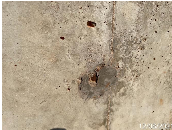
Foto 7.183: Superfície do concreto com vazios e ferragem exposta (Data da imagem: 12/08/2021)
