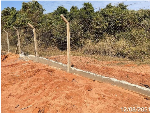
Foto 7.7: Base realizada sem acabamento adequado (Data da imagem: 11/08/2021)
