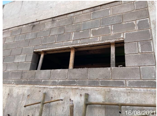
Foto 7.391: Superfície aparente de concreto irregular e ausência de acabamento (Data da imagem: 11/08/2021)
