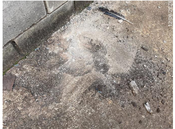
Foto 7.321: Superfície de concreto irregular (Data da imagem: 12/08/2021)
