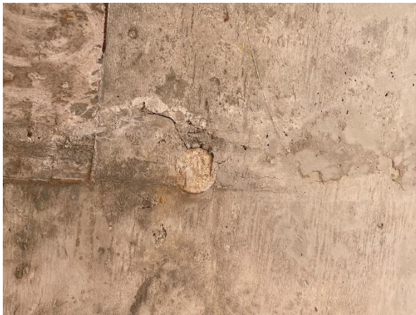
Foto 7.61: Superfície do concreto irregular – base da Rosca transportadora (Data da imagem: 11/08/2021)
