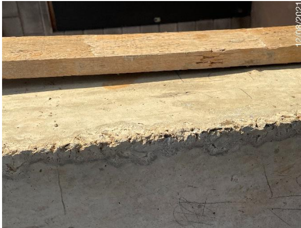
Foto 7.314: Arestas danificadas (Data da imagem: 12/08/2021)
