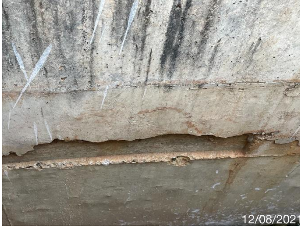
Foto 7.308: Superfície de concreto irregular com bicheira. (Data da imagem: 12/08/2021)
