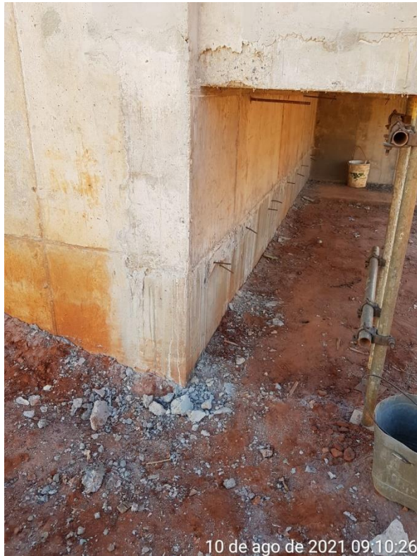
Foto 7.133: Presença de ferragens expostas e com marcas de formas na estrutura de concreto aparente (Data da imagem: 10/08/2021)
