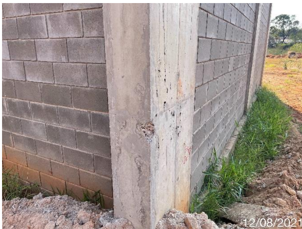
Foto 7.342: Estrutura com bicheira no concreto (Data da imagem: 12/08/2021)
