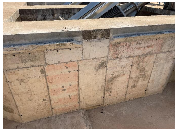
Foto 7.84: Marcas das formas nas superfícies de concreto e presença de núcleos perdidos (Data da imagem: 11/08/2021)
