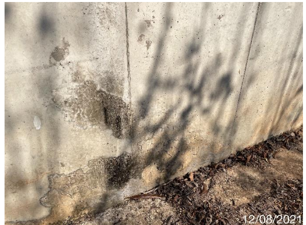
Foto 7.277: Superfície do concreto irregular e com marcas de formas no concreto (Data da imagem: 12/08/2021)
