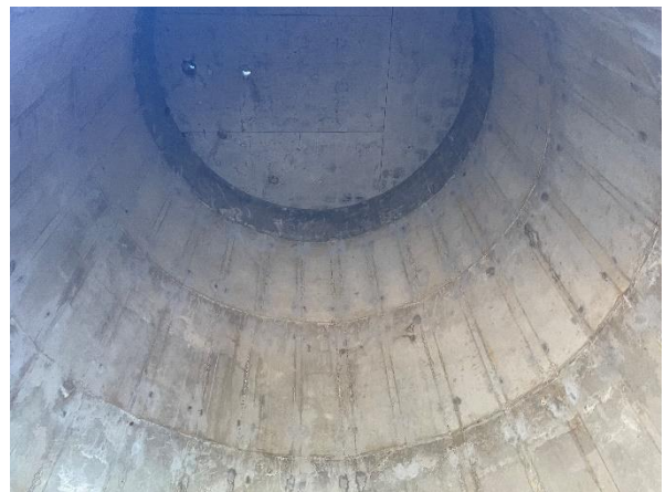
Foto 7.403: Marca de forma no concreto, (execução com forma inadequada) (Data da imagem: 11/08/2021)
