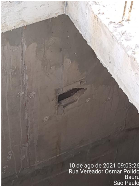
Foto 7.127: Arestas das aberturas de inspeção das lajes do UASB's danificadas e com nata de cimento (Data da imagem: 10/08/2021)
