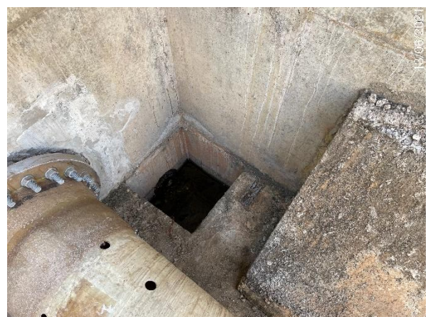
Foto 7.214: Superfície do concreto irregular, com presença de taliscas de madeiras e estruturas divisórias incompletas (Data da imagem: 13/08/2021)
