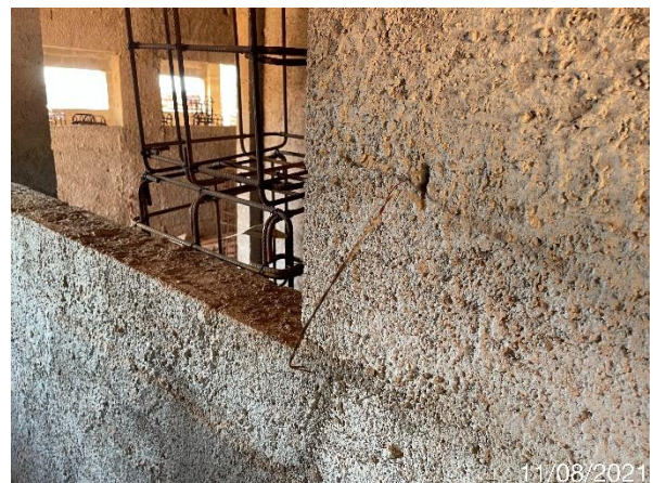
Foto 7.429: Ferragem exposta (Data da imagem: 11/08/2021)
