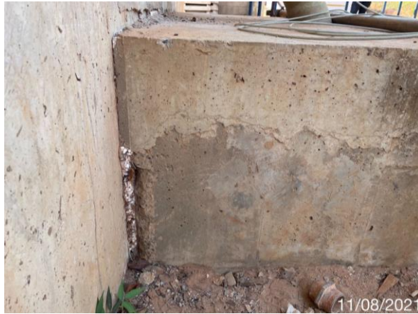
Foto 7.95: Arestas da estrutura Caixa de Óleos e Graxas danificadas (Data da imagem: 11/08/2021)
