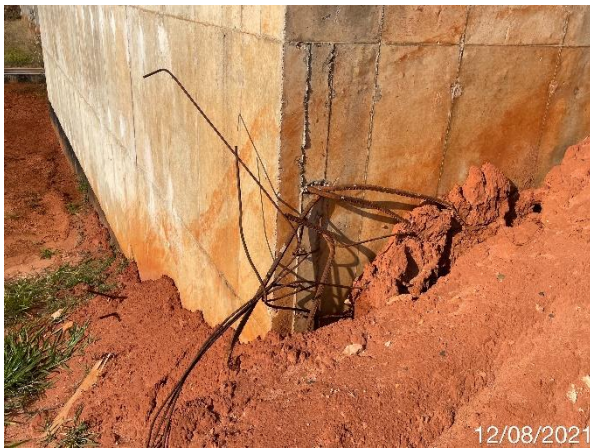
Foto 7.332: Ferragem exposta e danificada (Data da imagem: 12/08/2021)
