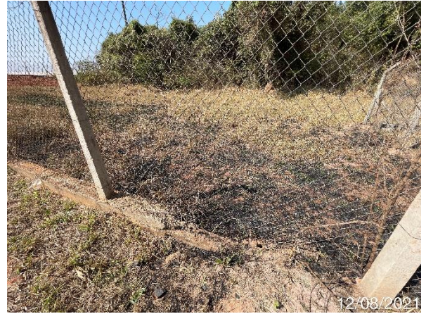
Foto 7.6: Base danificada (Data da imagem: 12/08/2021)
