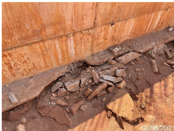
Foto 7.161: Presença de resíduos da construção (Data da imagem: 12/08/2021)
