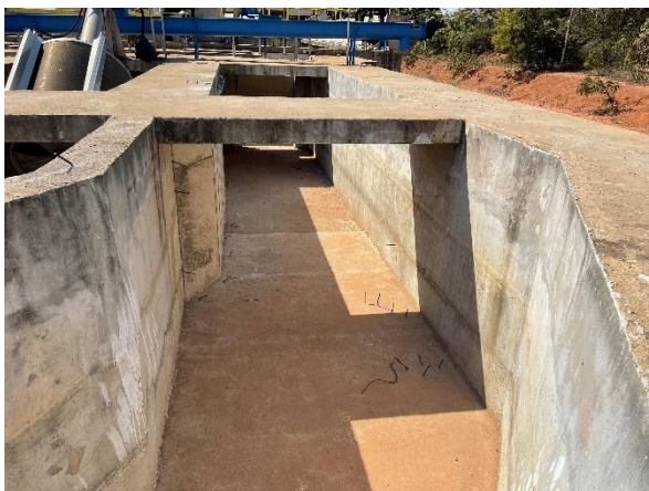
Foto 7.83: Marcas das formas nas superfícies de concreto e presença de ferragens expostas (Data da imagem: 11/08/2021)
