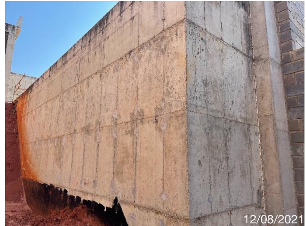
Foto 7.337: Superfície de concreto irregular, com marcas de formas no concreto (Data da imagem: 12/08/2021)
