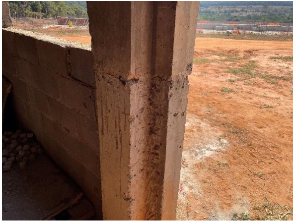
Foto 7.438: Superfície de concreto irregular e vazios de concretagem (Data da imagem: 11/08/2021)
