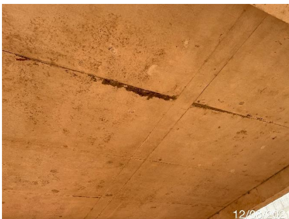
Foto 7.470: Marca de forma no concreto (Data da imagem: 12/08/2021)
