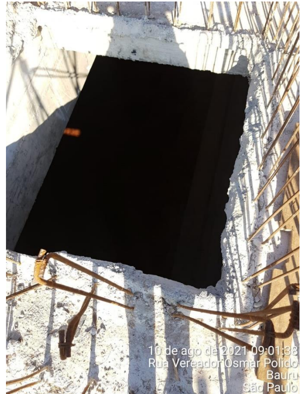
Foto 7.128: Arestas das aberturas de inspeção das lajes do UASB's danificadas e presença de ferragens expostas (Data da imagem: 11/08/2021)
