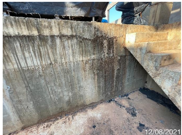
Foto 7.313: Superfície de concreto irregular, com presença de fissuras e vazios de concretagem. (Data da imagem: 12/08/2021)
