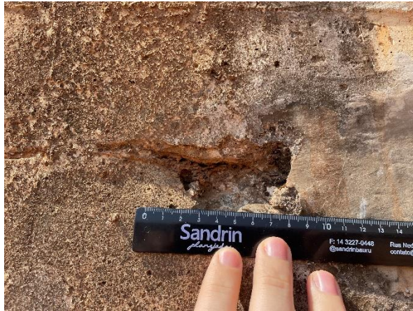
Foto 7.75: Superfície de concreto irregular (Data da imagem: 11/08/2021)
