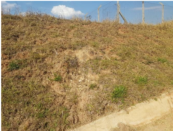
Foto 7.498: Solo irregular, necessário compactação do talude (Data da imagem: 11/08/2021)
