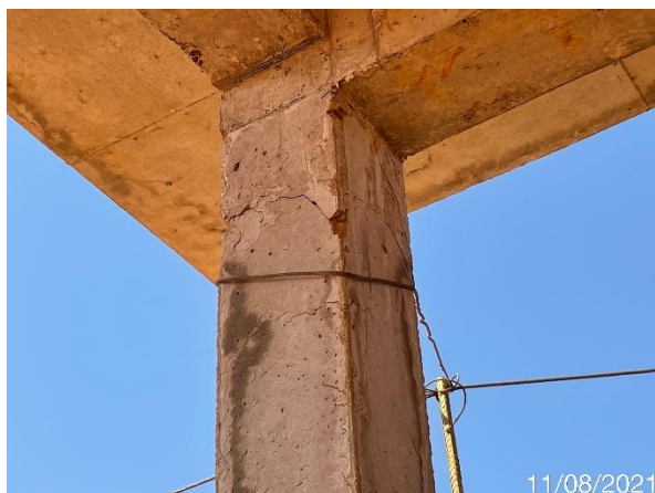
Foto 7.454: Presença fissuras e trincas (Data da imagem: 11/08/2021)
