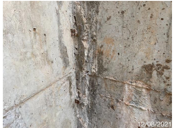
Foto 7.371: Superfície de concreto irregular (Data da imagem: 12/08/2021)
