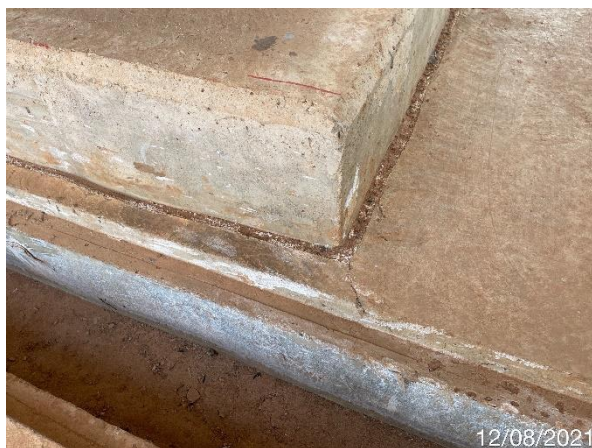
Foto 7.175: Fissuras na laje próximas aos vértices das bases de apoio dos sopradores (Data da imagem: 12/08/2021)
