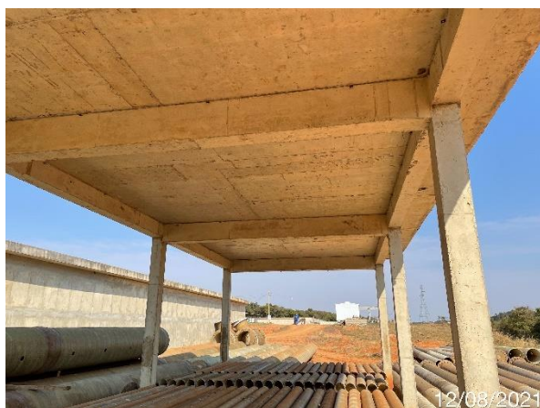
Foto 7.464: Presença de fissuras por toda a laje, vigas e pilares. Existência de núcleos perdidos (Data da imagem: 12/08/2021)
