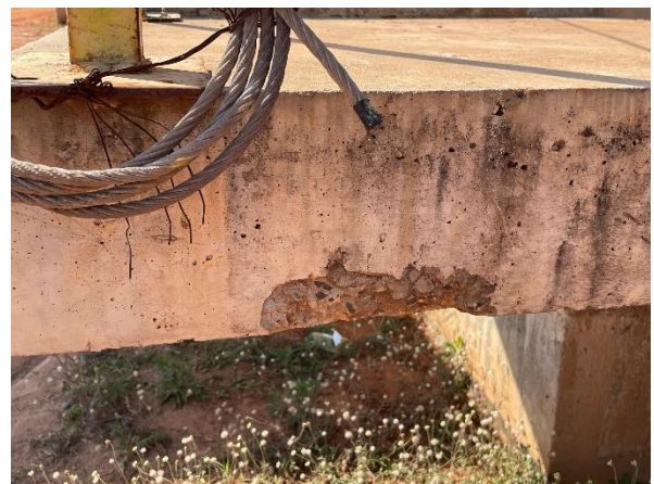
Foto 7.78: Superfície de concreto irregular e presença de vazios de concretagem (Data da imagem: 11/08/2021)
