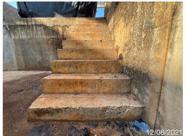
Foto 7.325: Escada danificada (Data da imagem: 12/08/2021)
