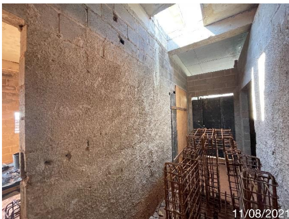
Foto 7.434: Serviços de chapisco incompletos, blocos de concreto quebrados (Data da imagem: 11/08/2021)
