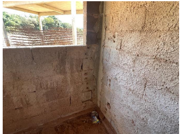
Foto 7.413: Ausência de chapisco (Data da imagem: 11/08/2021)
