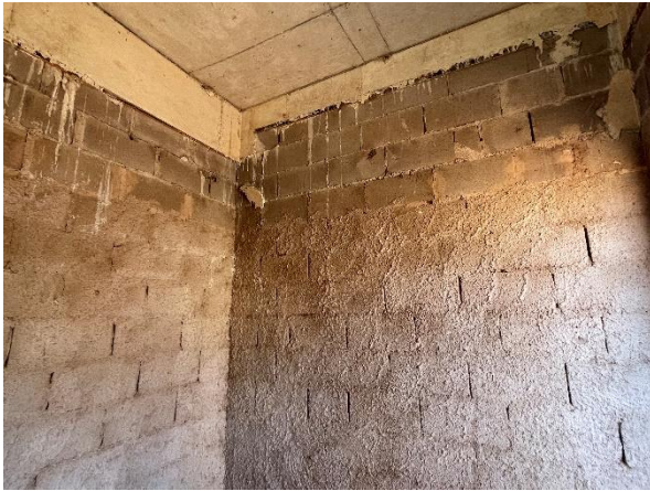
Foto 7.410: Formas de madeira nas vigas e ausência de chapisco (Data da imagem: 11/08/2021)
