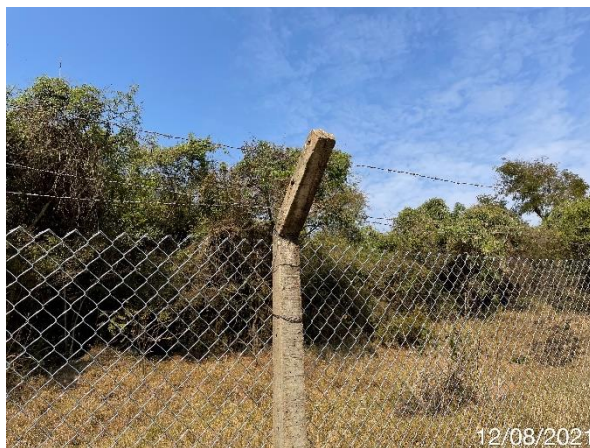
Foto 7.3: Necessário substituir os arames (Data da imagem: 12/08/2021)
