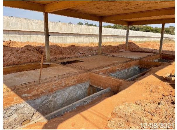
Foto 7.457: Ferragens da viga baldrame exposta sem proteção, ausência de impermeabilização na viga baldrame (Data da imagem: 12/08/2021)
