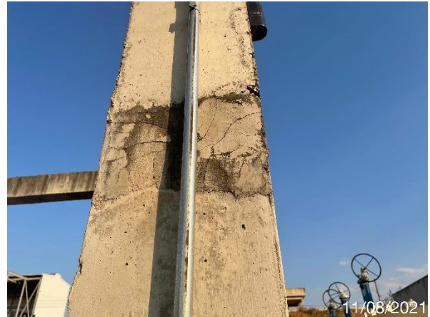
Foto 7.34: Superfície de concreto irregular e com presença de fissuras (Data da imagem: 11/08/2021)
