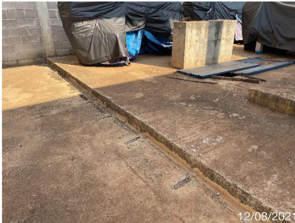
Foto 7.352: Presença de taliscas de madeira (Data da imagem: 12/08/2021)
