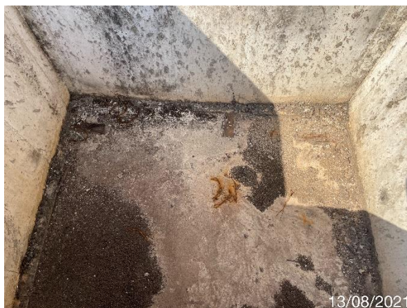
Foto 7.249: Ferragens expostas (Data da imagem: 13/08/2021)
