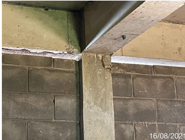
Foto 7.109: Marcas de formas na estrutura de concreto aparente e superfícies irregulares com trincas e fissuras (Data da imagem: 16/08/2021)
