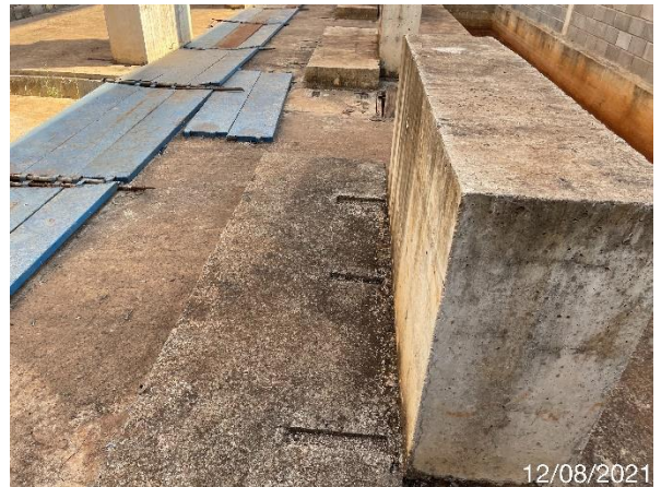
Foto 7.355: Superfície de concreto irregular, presença de fissuras e vazios de concretagem (Data da imagem: 12/08/2021)
