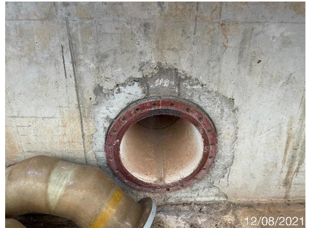
Foto 7.192: Superfície do concreto irregular, com presença de fissuras e com extremidade com dimensões diferentes do projeto (Data da imagem: 12/08/2021)
