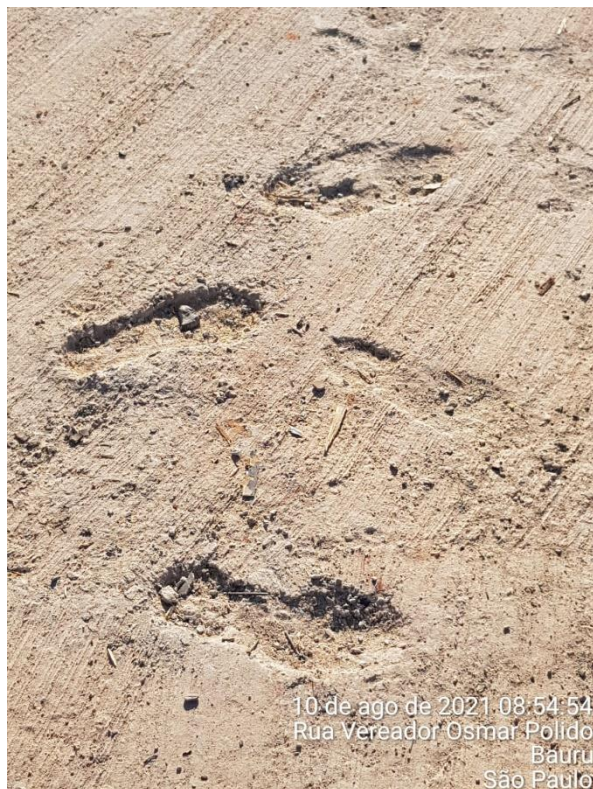
Foto 7.131 Irregularidade na superfície do concreto, com presença de fissuras e espaços vazios (Data da imagem: 10/08/2021)
