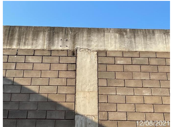
Foto 7.303: Superfície de concreto irregular, com presença de fissuras e trincas (Data da imagem: 12/08/2021)
