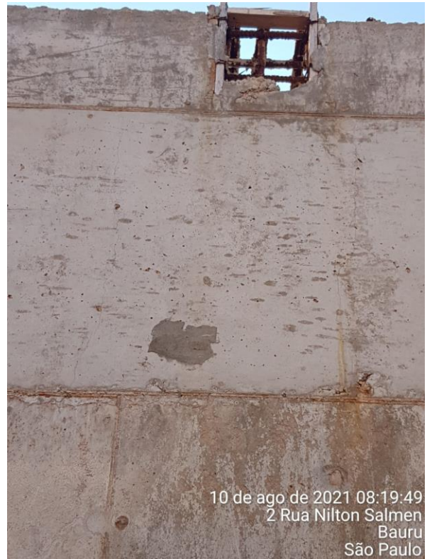
Foto 7.134: Vazios de concretagem e com arcos de formas na estrutura de concreto aparente (Data da imagem: 10/08/2021)
