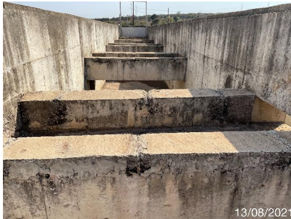
Foto 7.245: Estruturas de concreto danificadas (Data da imagem: 13/08/2021)
