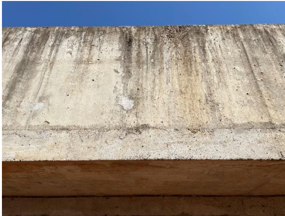
Foto 7.59: Superfície do concreto irregular, com marcas de forma e presença de fissuras (Data da imagem: 11/08/2021)
