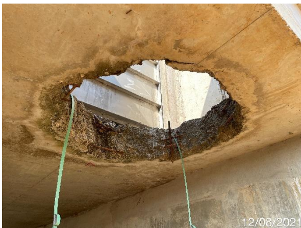
Foto 7.189: Ferragens expostas sem proteção adequada (Data da imagem: 12/08/2021)
