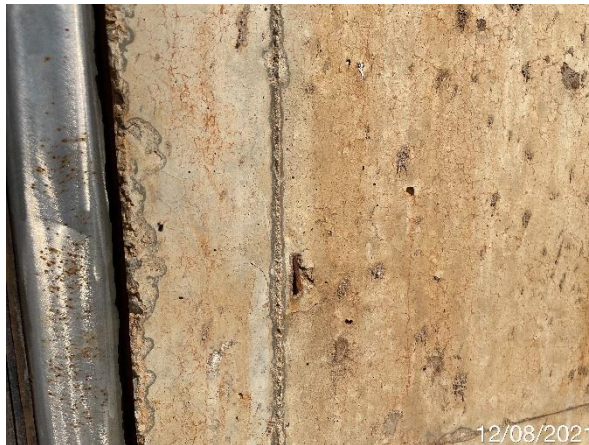
Foto 7.284: Superfície do concreto irregular com a presença de fissuras, marcas de formas no concreto e vazios de concretagem (Data da imagem: 12/08/2021)
