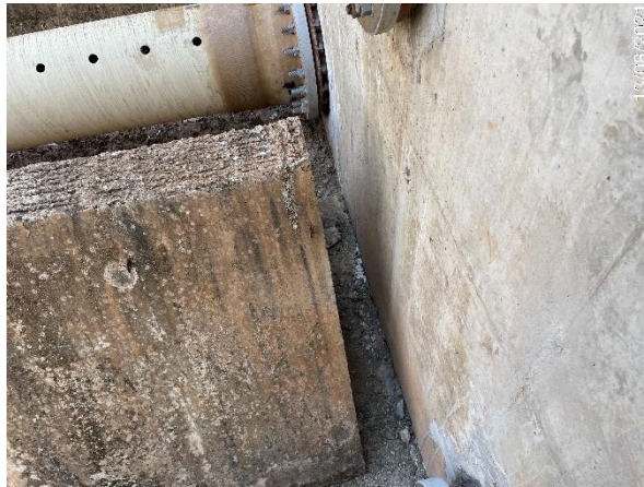
Foto 7.227: Estruturas divisórias incompletas (Data da imagem: 13/08/2021)
