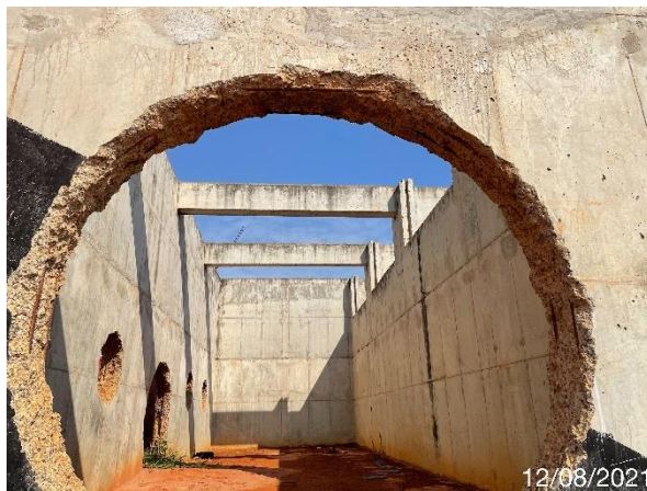
Foto 7.145: Ferragens expostas e existência de marcas de formas na estrutura de concreto (Data da imagem: 12/08/2021)
