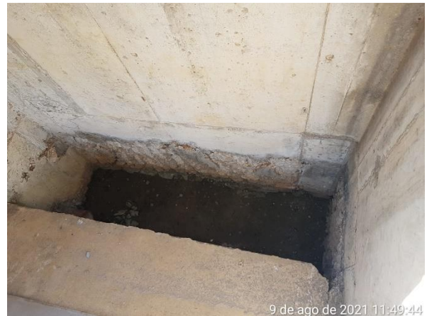
Foto 7.88: Superfície de concreto irregular e com marcas de formas no concreto (Data da imagem: 09/08/2021)
