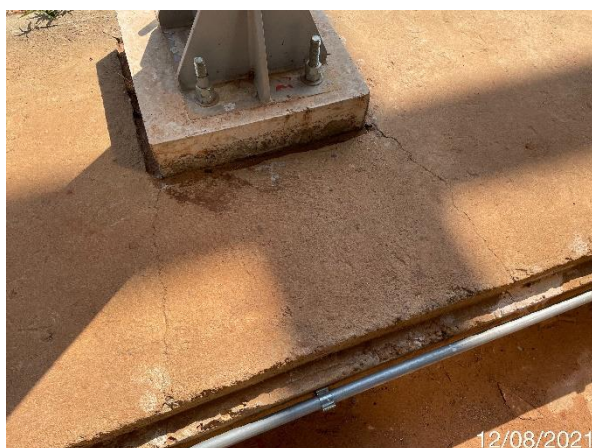
Foto 7.173: Fissuras na laje próxima aos vértices dos pilares (Data da imagem: 12/08/2021)
