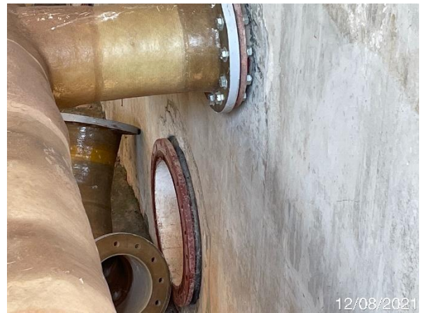
Foto 7.188: Superfície do concreto irregular e com presença de fissuras (Data da imagem: 12/08/2021)
