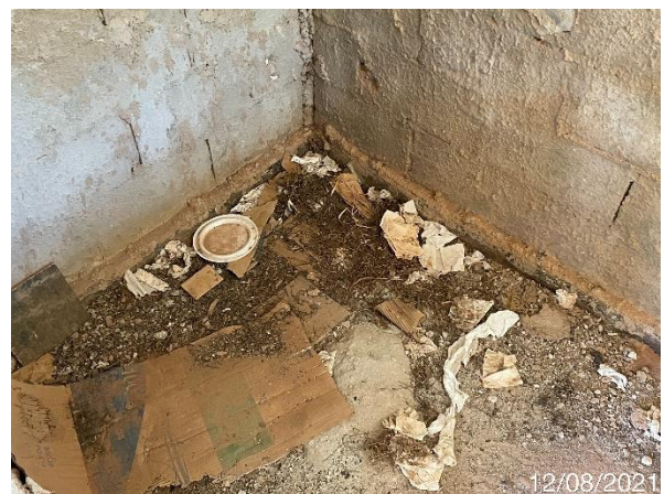
Foto 7.389: Ausência de limpeza no local (Data da imagem: 12/08/2021)
