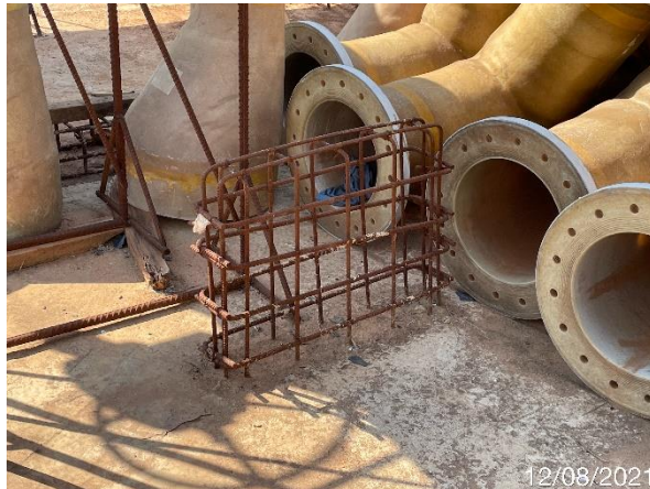
Foto 7.251: Ferragem exposta sem proteção adequada (Data da imagem: 12/08/2021)
