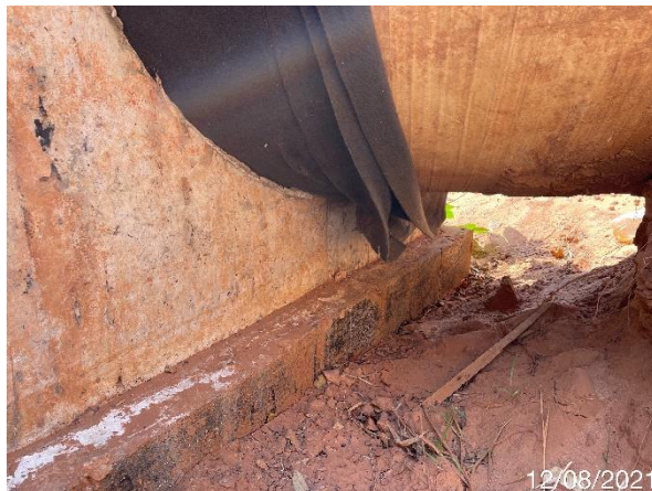
Foto 7.51: Bloco de ancoragem com presença de fissuras no concreto (Data da imagem: 12/08/2021)
