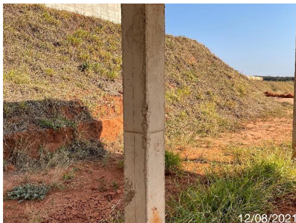
Foto 7.472: Marca de forma no concreto, presença de vazios de concretagem, bolhas e estrutura danificada (Data da imagem: 12/08/2021)
