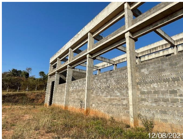
Foto 7.338: Aparência da Sala das Centrífugas (Data da imagem: 12/08/2021)
