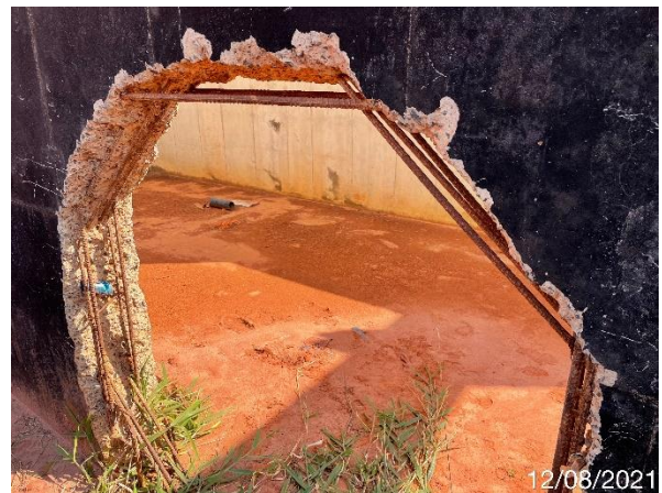
Foto 7.146: Ferragens expostas sem proteção adequada (Data da imagem: 12/08/2021)
