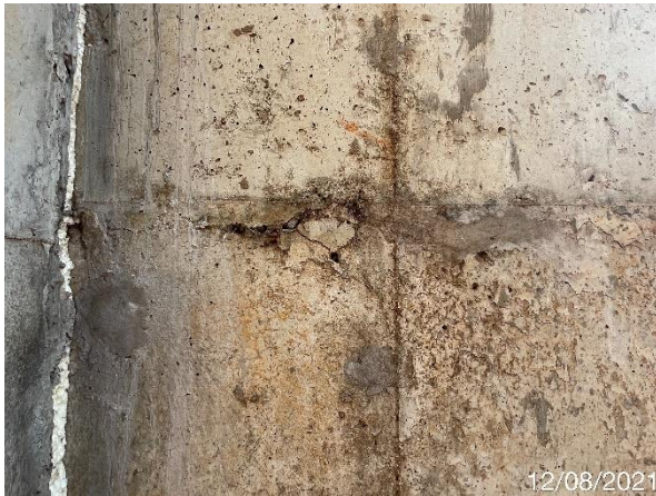
Foto 7.340: Superfície de concreto irregular com bicheira.(Data da imagem: 12/08/2021)
