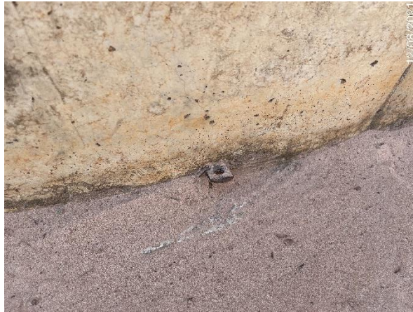
Foto 7.280: Presença de núcleo perdido (Data da imagem: 12/08/2021)
