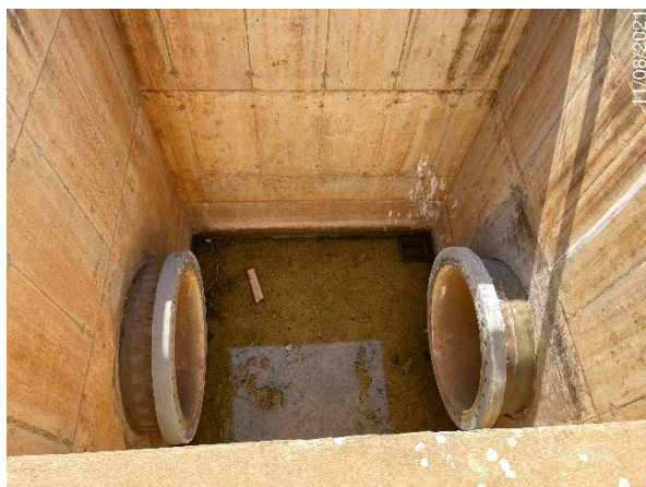
Foto 7.47: Superfície de concreto irregular com a presença de marcas de formas e fissuras (Data da imagem: 11/08/2021)
