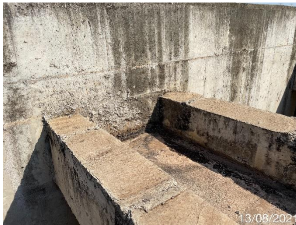
Foto 7.247: Superfície do concreto irregular e com presença de fissuras e passagem da canaleta sem passagem (Data da imagem: 13/08/2021)
