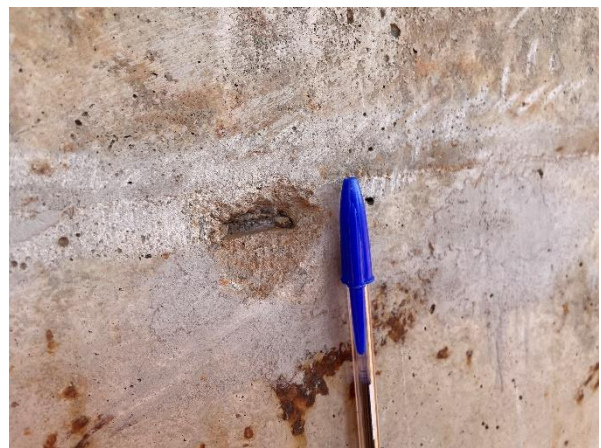
Foto 7.54: Superfície do concreto irregular com vestígio de faca. (Data da imagem: 11/08/2021)
