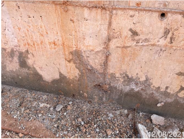
Foto 7.165: Superfície do concreto irregular com marcas de formas e presença de núcleos perdidos (Data da imagem: 12/08/2021)
