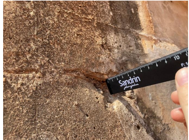
Foto 7.76: Superfície de concreto irregular (Data da imagem: 11/08/2021)
