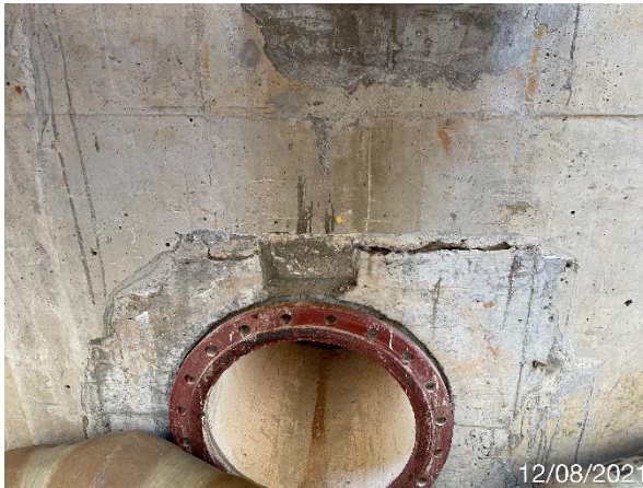
Foto 7.199: Superfície do concreto irregular, com presença de fissuras, trincas e extremidade com dimensões diferentes do projeto (Data da imagem: 12/08/2021)
