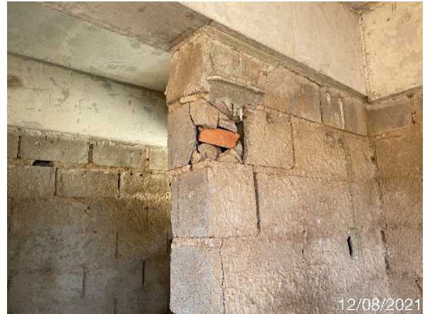
Foto 7.385: Alvenaria com blocos quebrados e áreas que não foram executado chapisco (Data da imagem: 12/08/2021)
