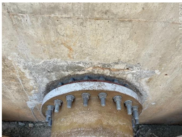
Foto 7.231: Superfície do concreto irregular, presença de vazios de concretagem e estrutura danificada (Data da imagem: 13/08/2021)
