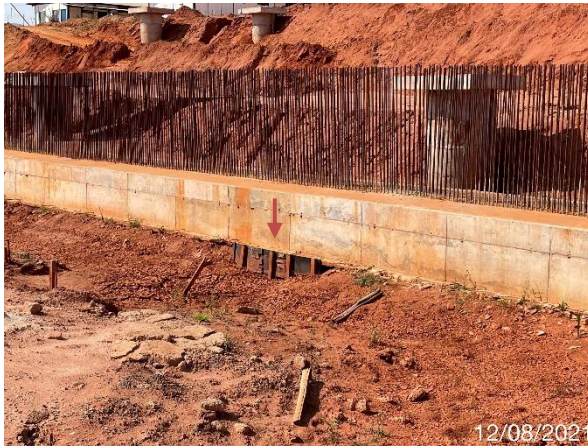
Foto 7.169: Ausência de impermeabilização interna, com presença de fissuras na estrutura de concreto (Data da imagem: 12/08/2021)
