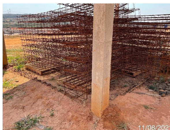
Foto 7.479: Ferragem da viga baldrame exposta sem proteção e danificadas (Data da imagem: 11/08/2021)
