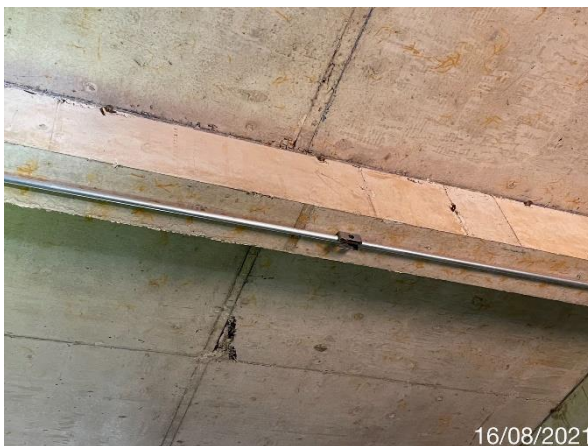
Foto 7.107: Marcas de formas na estrutura de concreto aparente e superfícies irregulares (Data da imagem: 16/08/2021)
