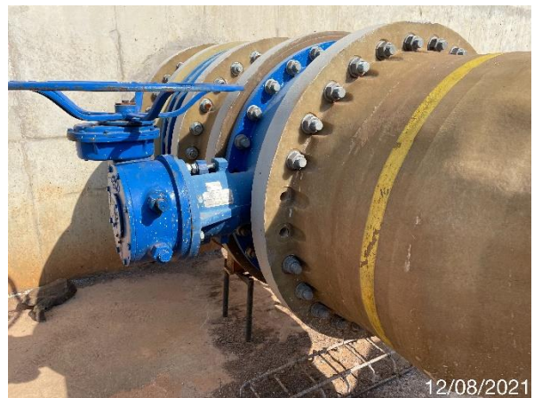
Foto 7.258: Ausência de parafusos nas conexões (Data da imagem: 12/08/2021)
