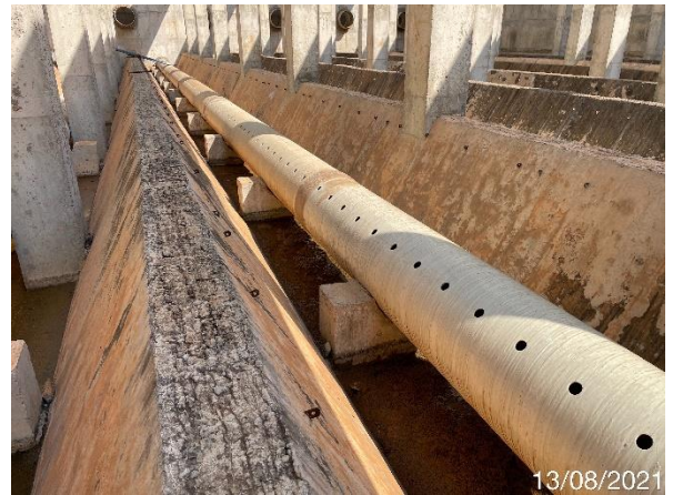
Foto 7.242: Estruturas divisórias incompletas, presença de núcleos perdidos (Data da imagem: 13/08/2021)
