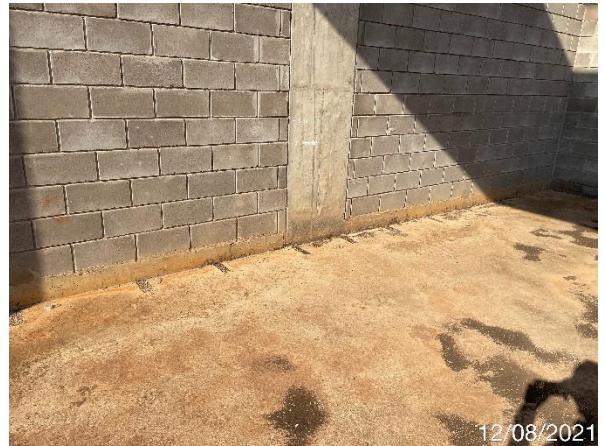
Foto 7.353: Presença de taliscas de madeira (Data da imagem: 12/08/2021)
