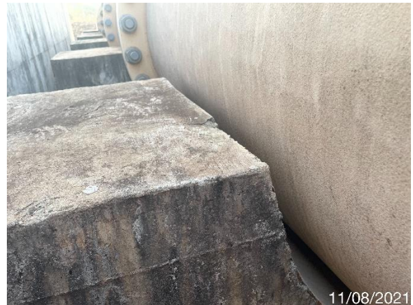
Foto 7.38: Folgas nos berços de apoio das tubulações (Data da imagem: 11/08/2021)
