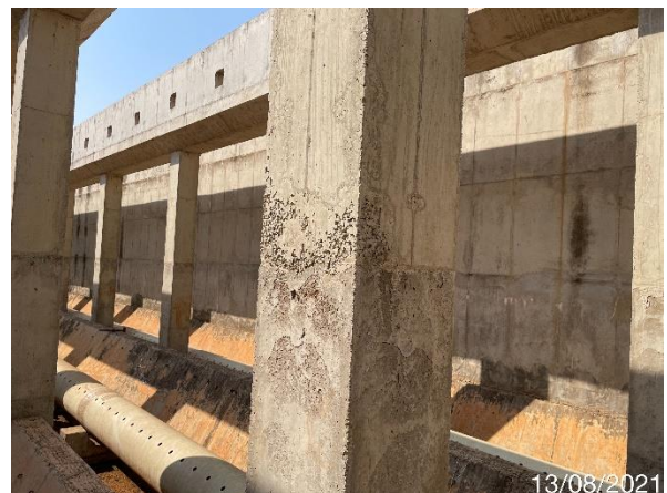
Foto 7.232: Superfície do concreto irregular com presença e vazios de concretagem (Data da imagem: 13/08/2021)
