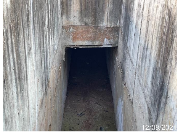
Foto 7.309: Superfície de concreto irregular, com presença de fissuras e trincas (Data da imagem: 12/08/2021)
