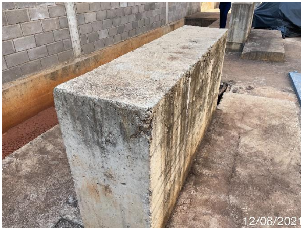
Foto 7.358: Superfície de concreto irregular e estrutura danificada (Data da imagem: 12/08/2021)
