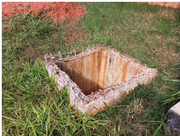
Foto 7.290: Presença de ferragens sem proteção, ausência da tampa da caixa e estrutura danificada (Data da imagem: 11/08/2021)
