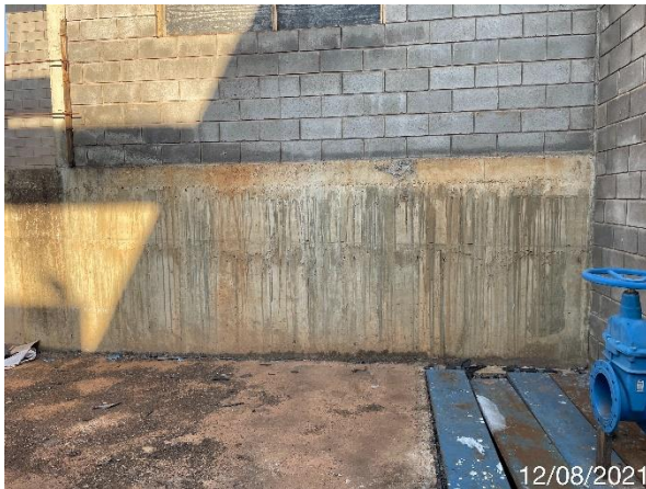
Foto 7.322: Superfície de concreto irregular (Data da imagem: 12/08/2021)
