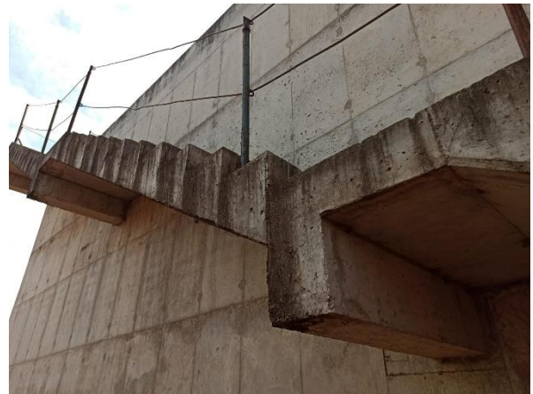
Foto 7.295: Marcas de formas na estrutura de concreto aparente e estrutura da escada danificada (Data da imagem: 11/08/2021)
