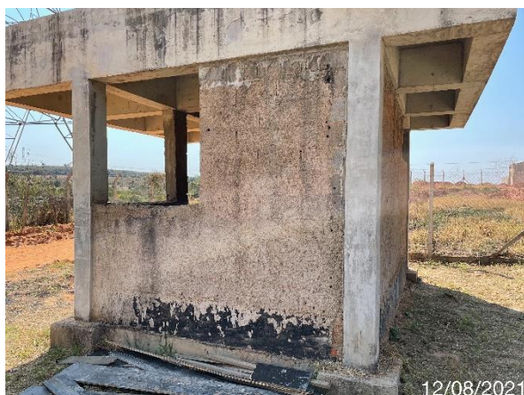
Foto 7.382: Alvenaria danificada e impermeabilização incompleta (Data da imagem: 12/08/2021)
