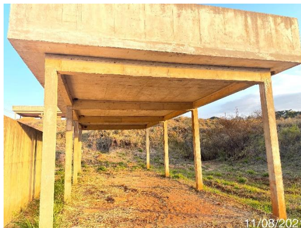
Foto 7.445: Aparência da subestação elétrica SE-02 (Data da imagem: 11/08/2021)
