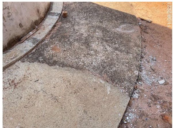
Foto 7.401: Calçada com fissuras (Data da imagem: 11/08/2021)
