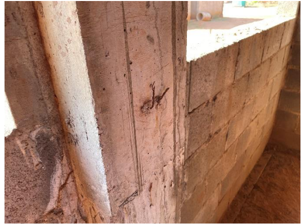
Foto 7.439: Presença de núcleo perdido e superfície de concreto irregular (Data da imagem: 11/08/2021)
