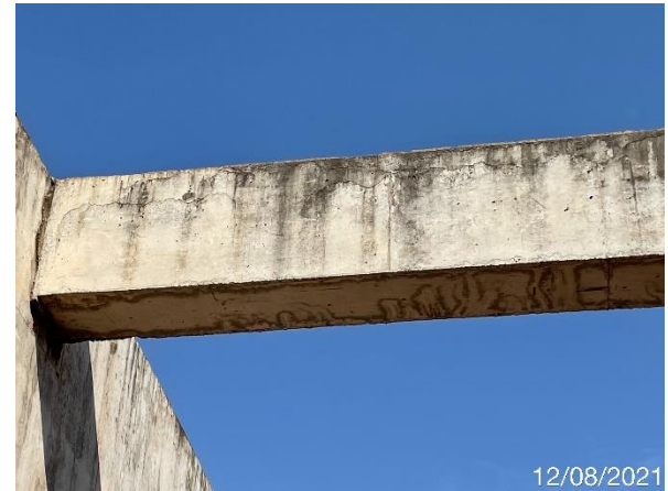
Foto 7.148: Existência de fissuras nas vigas (Data da imagem: 12/08/2021)
