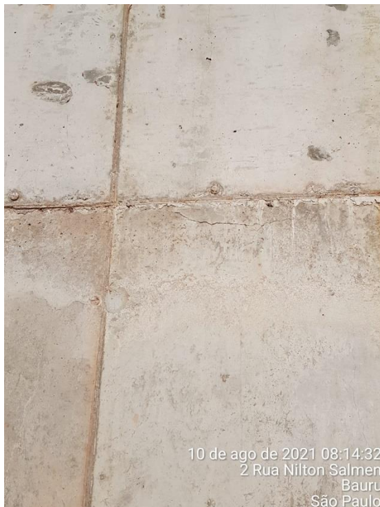
Foto 7.113: Superfície do concreto com irregularidades e marcas das formas (Data da imagem: 10/08/2021)
