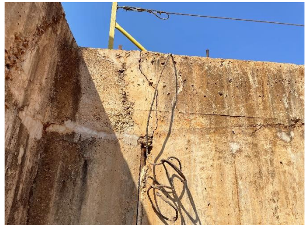
Foto 7.72: Superfície do concreto irregular, com marcas de formas, trincas e fissuras (Data da imagem: 11/08/2021)
