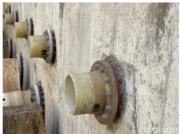
Foto 7.226: Estrutura sem acabamento nos inserts e, presença de fissuras e vazios de concretagem, ausência de tubulações (Data da imagem: 13/08/2021)
