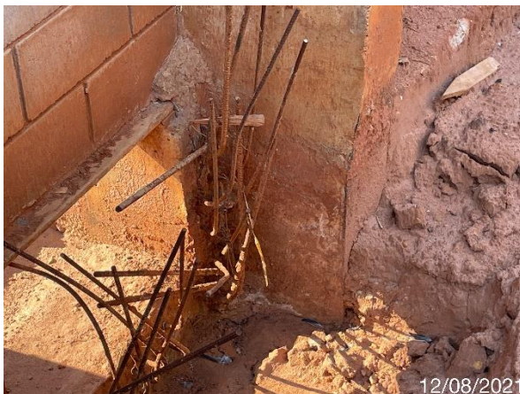
Foto 7.350: Ferragem exposta sem a proteção adequada (Data da imagem: 12/08/2021)
