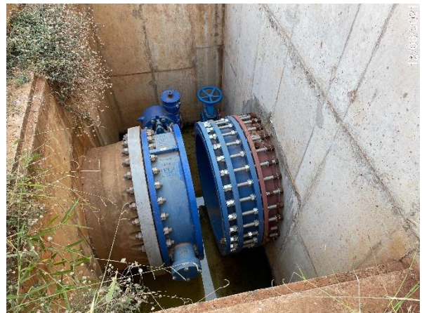
Foto 7.204: Ausência de conexão entre as tubulações (Data da imagem: 12/08/2021)
