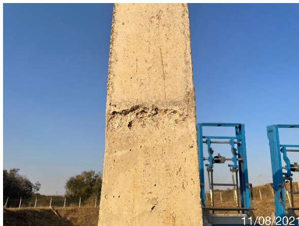
Foto 7.35: Espaços vazios detectados ao desformar a estrutura de concreto armado (Bicheiras) (Data da imagem: 11/08/2021)
