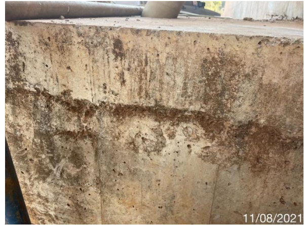
Foto 7.96: Vazios de concretagem (Data da imagem: 11/08/2021)
