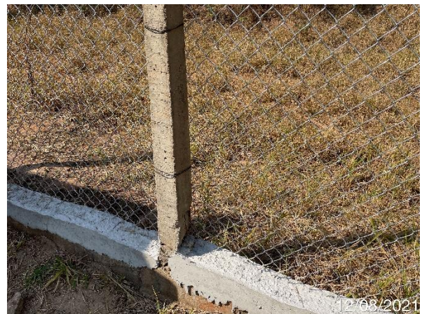
Foto 7.2: Superfície de concreto irregular (Data da imagem: 12/08/2021)
