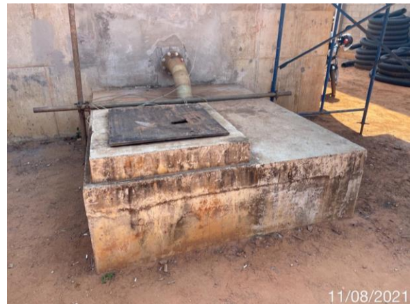
Foto 7.98: Superfície do concreto com irregularidades e sem a instalação da tampa (Data da imagem: 11/08/2021)
