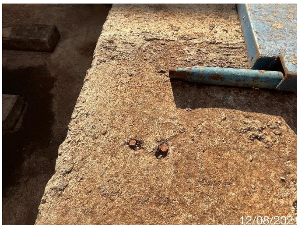
Foto 7.356: Superfície de concreto irregular e ferragem exposta (Data da imagem: 12/08/2021)
