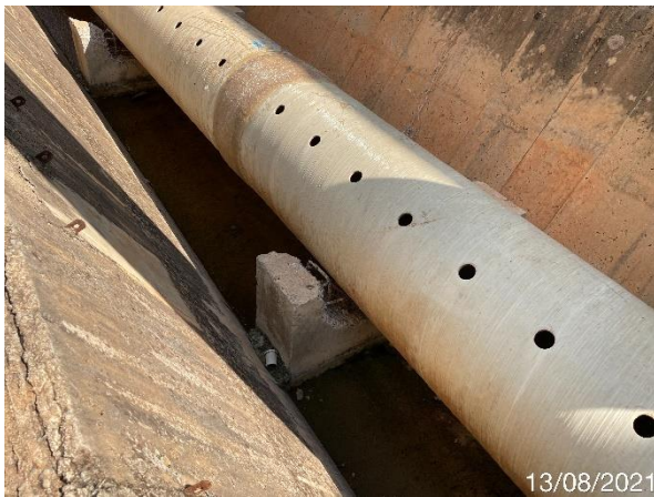
Foto 7.223: Berço de apoio das tubulações danificados e com presença de núcleos perdidos (Data da imagem: 13/08/2021)
