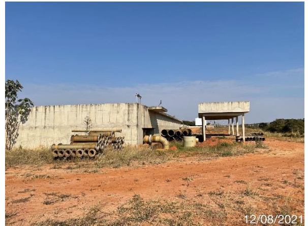
Foto 7.186: Aparência externa dos Decantadores e armazenamento da tubulação (Data da imagem: 12/08/2021)
