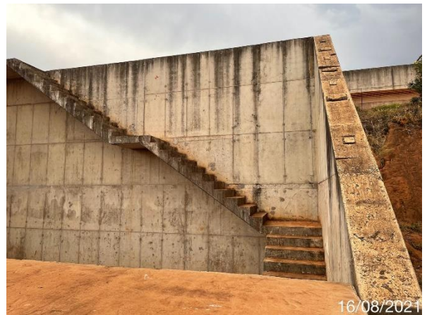
Foto 7.124: Superfície de concreto irregular, marcas das formas e vazios de concretagem (Data da imagem: 16/08/2021)
