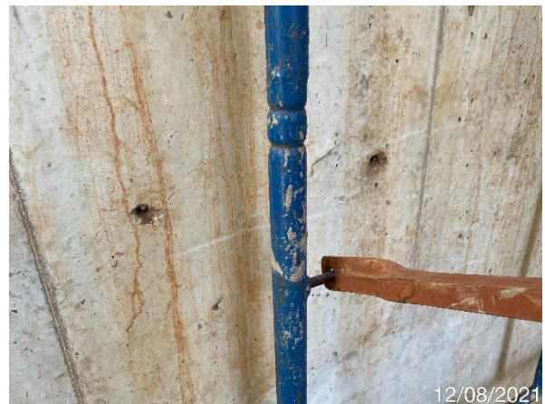
Foto 7.202: Superfície do concreto irregular (Data da imagem: 12/08/2021)
