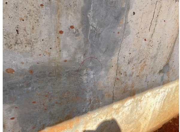
Foto 7.70: Presença de bolhas e fissuras (Data da imagem: 11/08/2021)
