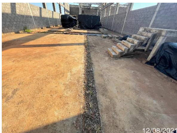
Foto 7.300: Limpeza das canaletas (Data da imagem: 12/08/2021)
