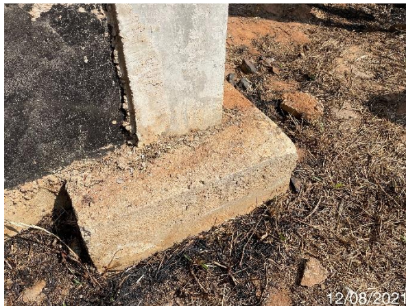
Foto 7.380: Ausência de impermeabilização (Data da imagem: 12/08/2021)
