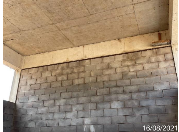
Foto 7.104: Marcas de formas na estrutura da laje de concreto (Data da imagem: 16/08/2021)
