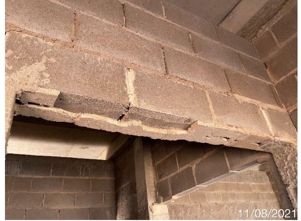
Foto 7.431: Serviço de requadro danificado (Data da imagem: 11/08/2021)
