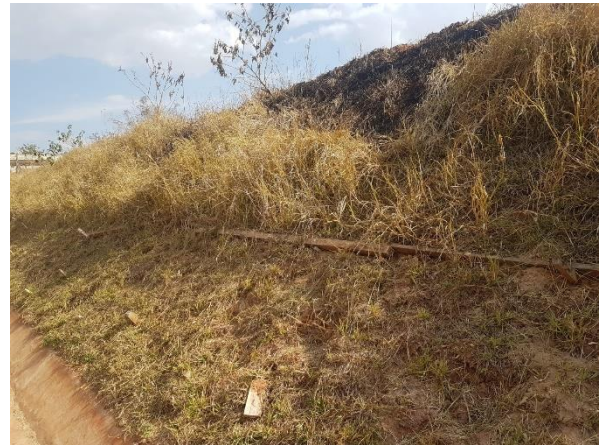
Foto 7.499: Solo irregular, necessário compactação do talude, capinar e aparar a vegetação (Data da imagem: 11/08/2021)
