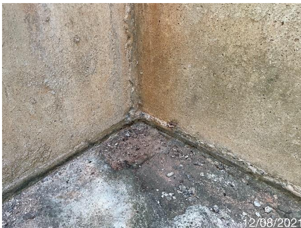
Foto 7.201: Presença de fungo na laje (Data da imagem: 12/08/2021)
