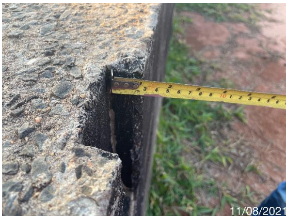
Foto 7.21: Detalhe não previsto em projeto (Data da imagem: 11/08/2021)
