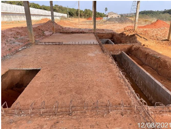
Foto 7.458: Ferragens da viga baldrame exposta sem proteção e ausência de impermeabilização na viga baldrame (Data da imagem: 12/08/2021)
