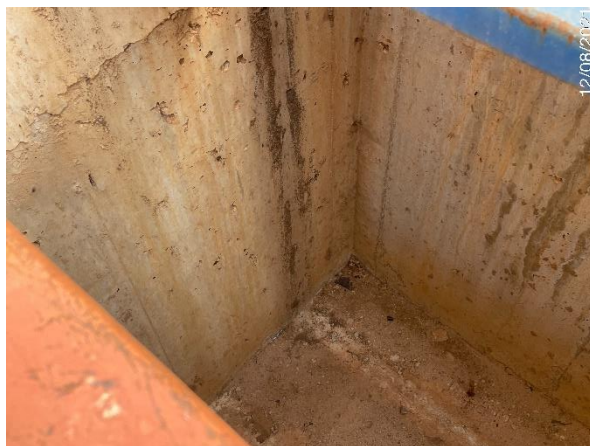
Foto 7.374: Superfície de concreto irregular e com presença de fissuras (Data da imagem: 12/08/2021)
