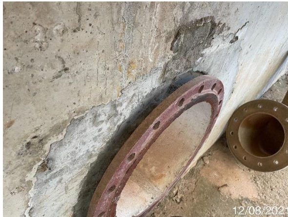
Foto 7.191: Superfície do concreto irregular, com presença de fissuras e com extremidade com dimensões diferentes do projeto (Data da imagem: 12/08/2021)
