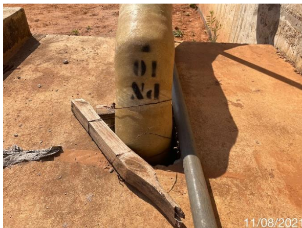
Foto 7.93: Ausência de acabamento na entrada da tubulação de Ø150 mm (Data da imagem: 11/08/2021)
