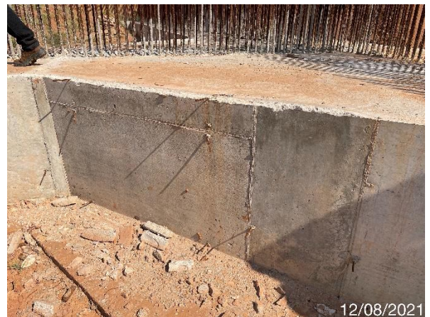
Foto 7.168: Superfície do concreto irregular com marcas de formas, presença de ferragens expostas e resíduos de concreto (Data da imagem: 12/08/2021)
