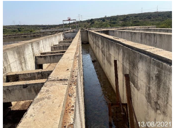
Foto 7.246: Superfície do concreto irregular, com presença de vazios de concretagem, bolhas e água na canaleta (Data da imagem: 13/08/2021)
