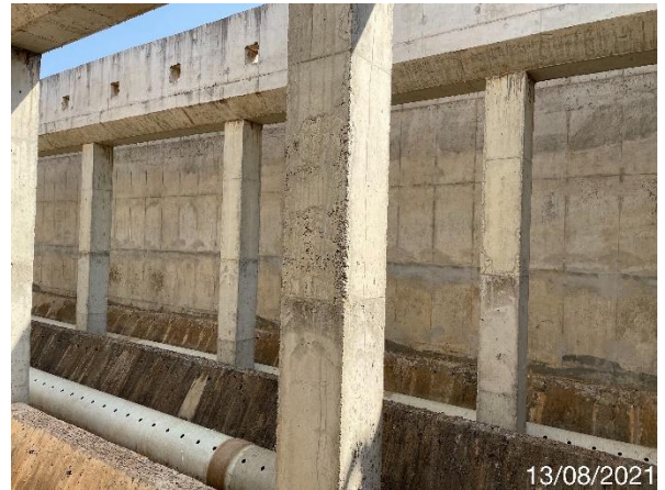
Foto 7.216: Superfície do concreto irregular com presença de vazios de concretagem (Data da imagem: 13/08/2021)
