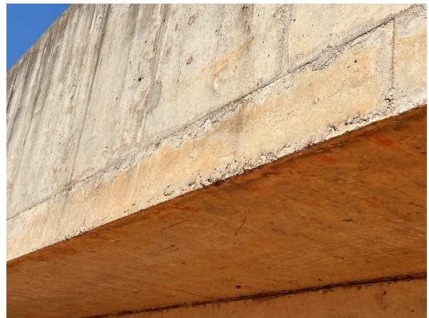
Foto 7.58: Superfície do concreto irregular e com marcas de forma (Data da imagem: 11/08/2021)
