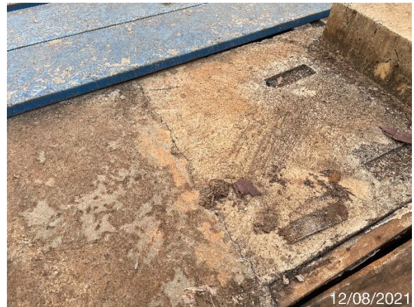
Foto 7.361: Superfície de concreto irregular (Data da imagem: 12/08/2021)
