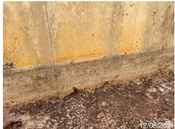
Foto 7.283: Superfície do concreto irregular com a presença de fissuras, marcas de formas no concreto e vazios de concretagem (Data da imagem: 12/08/2021)
