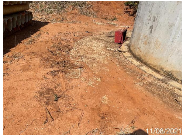
Foto 7.399: Calçada danificada (Data da imagem: 11/08/2021)
