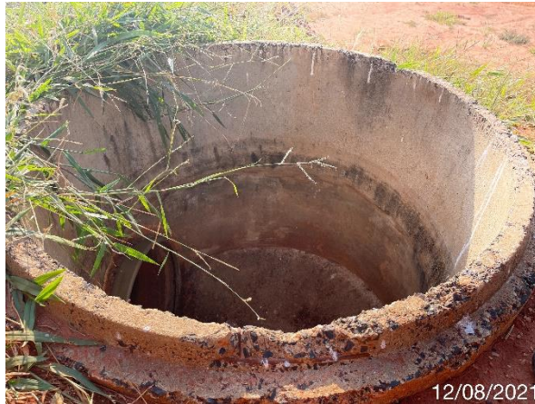
Foto 7.336: Estrutura danificada e ausência da tampa (Data da imagem: 12/08/2021)
