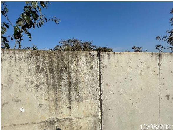
Foto 7.272: Estrutura de concreto danificada (Data da imagem: 12/08/2021)
