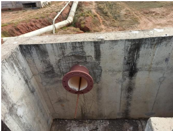
Foto 7.294: Marcas de formas na estrutura de concreto aparente, presença de fissuras e irregularidades na superfície ao redor da tubulação (Data da imagem: 11/08/2021)
