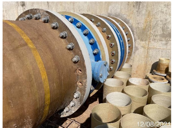
Foto 7.256: Ausência de parafusos nas conexões (Data da imagem: 12/08/2021)
