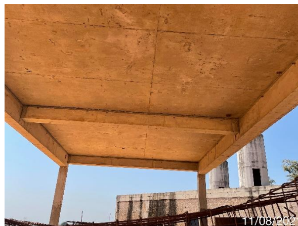
Foto 7.475: Marcas de forma no concreto e núcleos perdidos (Data da imagem: 11/08/2021)
