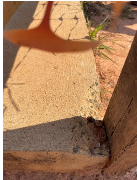
Foto 7.50: Arestas da estrutura danificadas e ferragens expostas (Data da imagem: 11/08/2021)
