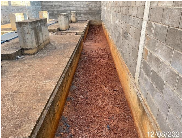
Foto 7.360: Ausência da tampa e assoreamento. (Data da imagem: 12/08/2021)
