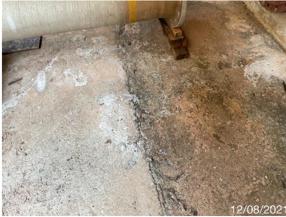
Foto 7.197: Presença de fissuras e trincas na laje (Data da imagem: 12/08/2021)
