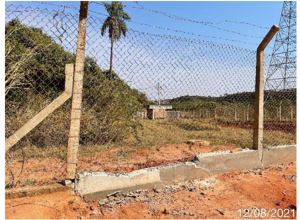
Foto 7.8: Base executada sem acabamento adequado (Data da imagem: 12/08/2021)
