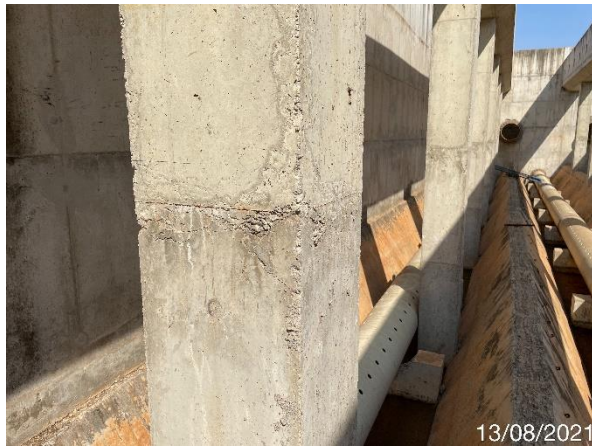
Foto 7.241: Superfície de concreto irregular e estruturas divisórias incompletas (Data da imagem: 13/08/2021)
