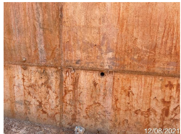
Foto 7.162: Superfície do concreto com marcas de formas e com núcleos perdidos (Data da imagem: 12/08/2021)
