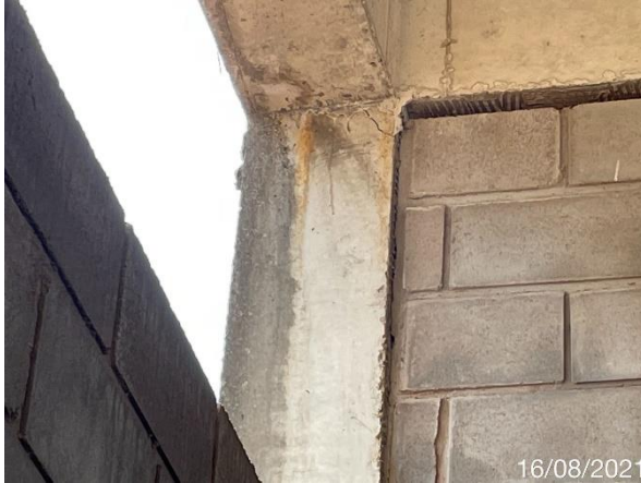
Foto 7.103: Irregularidade na superfície do concreto e presença de trincas entre vigas e pilares (Data da imagem: 16/08/2021)
