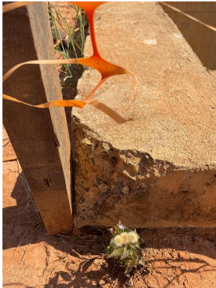
Foto 7.49: Arestas da estrutura danificadas e ferragens expostas (Data da imagem: 11/08/2021)
