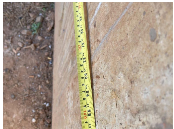
Foto 7.100: Caixa executada com medidas que diferem do projeto (Data da imagem: 11/08/2021)
