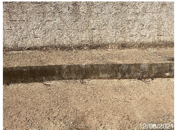
Foto 7.489: Presença de ferragem na arquibancada (Data da imagem: 12/08/2021)
