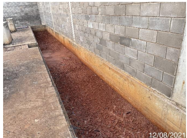
Foto 7.351: Ausência da tampa na canaleta (Data da imagem: 12/08/2021)
