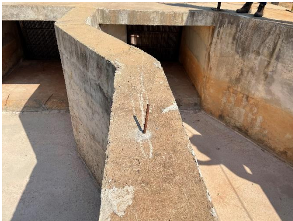
Foto 7.81: Presença de ferragens expostas (Data da imagem: 11/08/2021)
