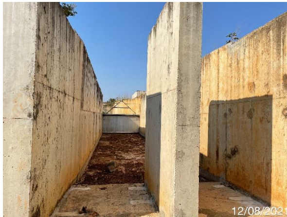
Foto 7.262: Marcas de formas no concreto (Data da imagem: 12/08/2021)
