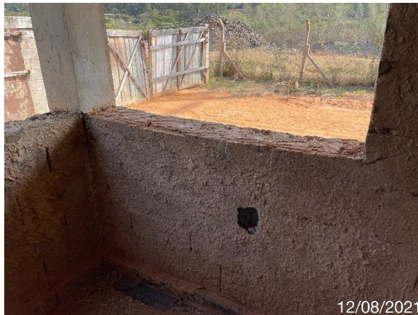
Foto 7.386: : Alvenaria com blocos quebrados (Data da imagem: 12/08/2021)
