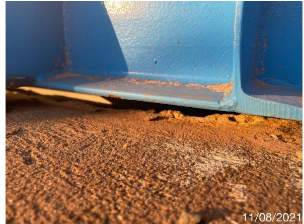
Foto 7.24: Equipamento não apoiado adequadamente (Data da imagem: 11/08/2021)
