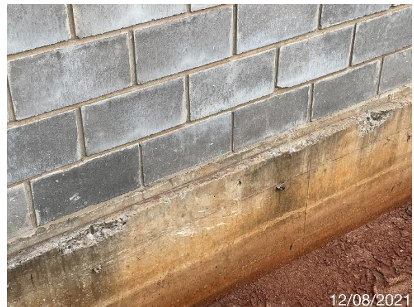
Foto 7.363: Estrutura danificada e presença de núcleos perdidos (Data da imagem: 12/08/2021)
