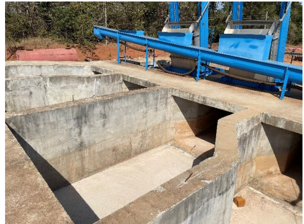
Foto 7.80: Presença de ferragens expostas e tubulação de retorno do equipamento danificada (Data da imagem: 11/08/2021)
