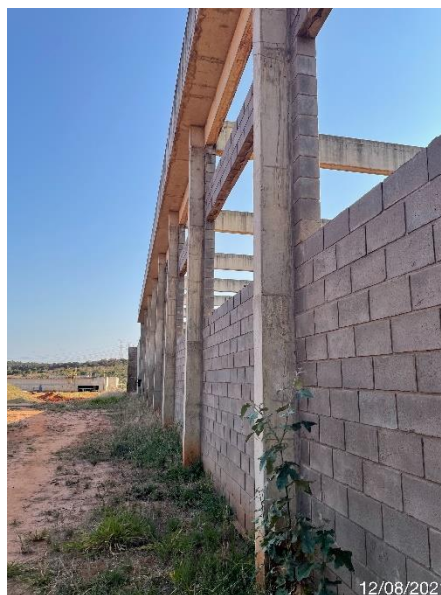
Foto 7.299: Superfície de concreto irregular com a presença de vazios de concretagem, bolhas e fissuras (Data da imagem: 12/08/2021)
