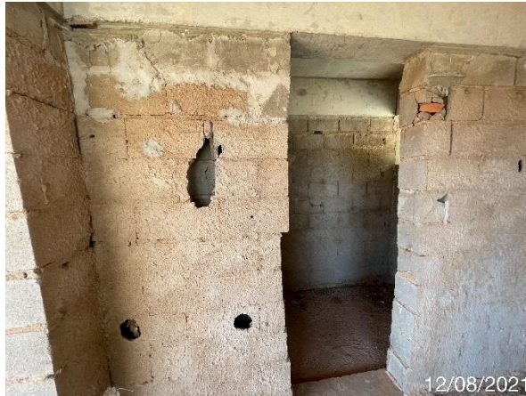
Foto 7.384: : Alvenaria com blocos quebrados e áreas que não foram executado chapisco (Data da imagem: 12/08/2021)
