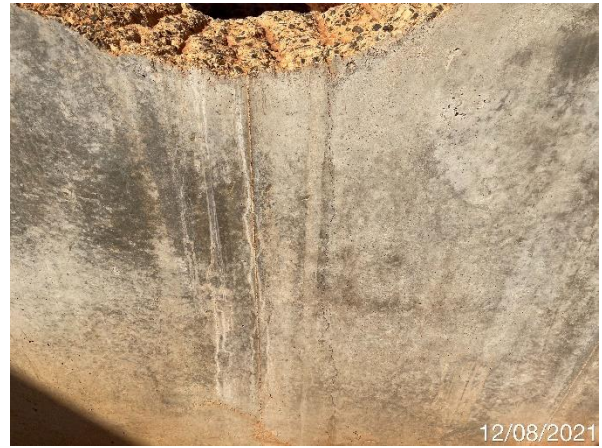
Foto 7.144: Presença de fissuras na estrutura de concreto (Data da imagem: 12/08/2021)
