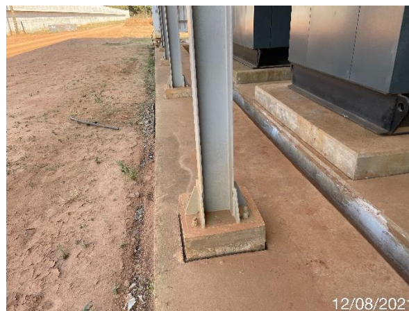
Foto 7.176: Ausência da grade das canaletas (Data da imagem: 12/08/2021)
