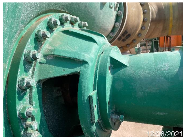
Foto 7.260: Ausência de parafusos (Data da imagem: 12/08/2021)
