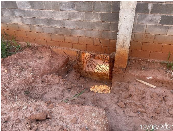
Foto 7.346: Ferragem exposta sem a proteção adequada (Data da imagem: 12/08/2021)
