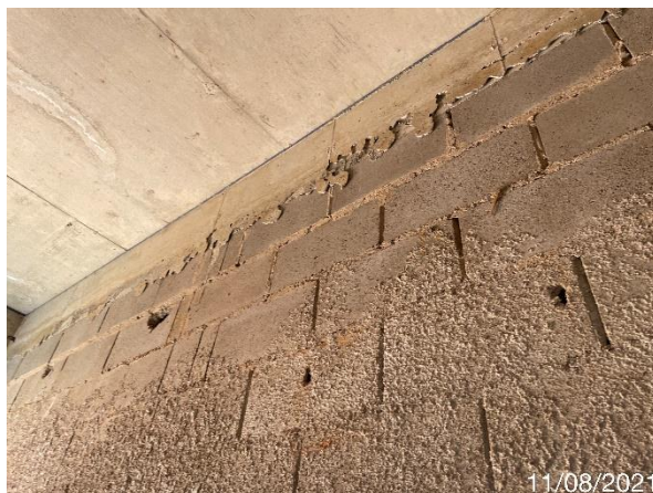
Foto 7.428: Serviços de chapisco incompletos e blocos quebrados (Data da imagem: 11/08/2021)
