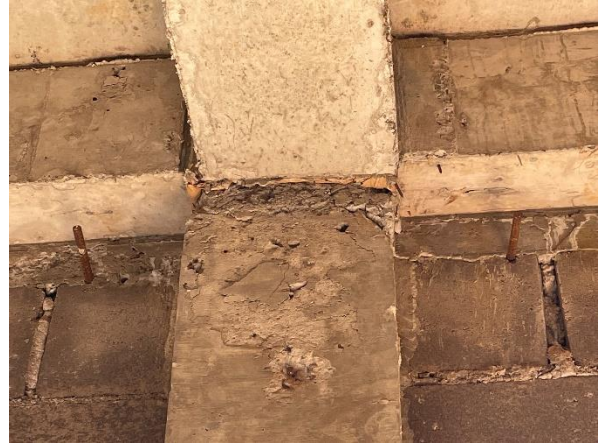
Foto 7.437: Ferragens expostas, presença de fissuras e trincas (Data da imagem: 11/08/2021)
