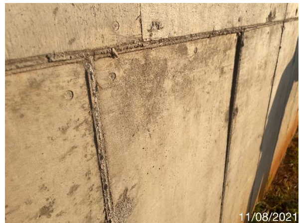
Foto 7.12: Superfície do concreto com irregularidades e marcas das formas (Data da imagem: 11/08/2021)
