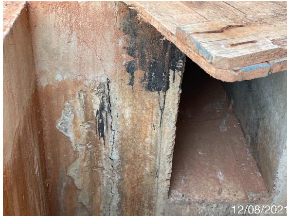
Foto 7.326: Superfície de concreto irregular, com presença de fissuras (Data da imagem: 12/08/2021)
