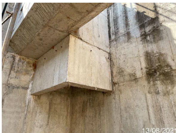
Foto 7.213: Superfície do concreto irregular, com presença de núcleos perdidos e fissuras no concreto (Data da imagem: 13/08/2021)
