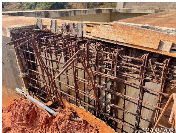
Foto 7.328: Ferragens expostas sem proteção adequada e com fissuras (Data da imagem: 12/08/2021)
