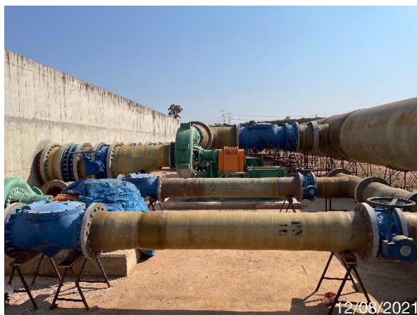
Foto 7.259: Ausência do berço de apoio das tubulações (Data da imagem: 12/08/2021)
