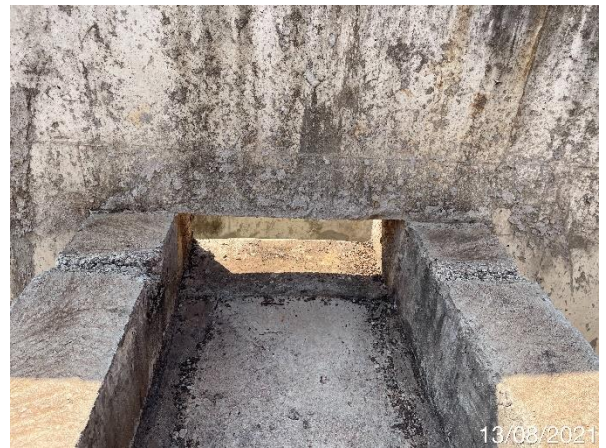
Foto 7.248: Superfície do concreto irregular (Data da imagem: 13/08/2021)
