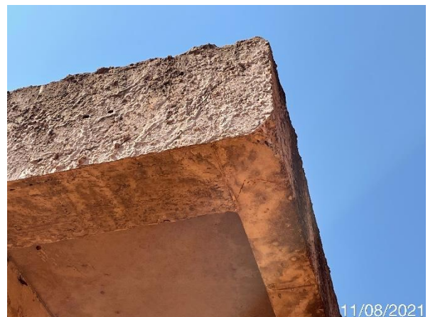
Foto 7.423: Presença de fissuras (Data da imagem: 11/08/2021)
