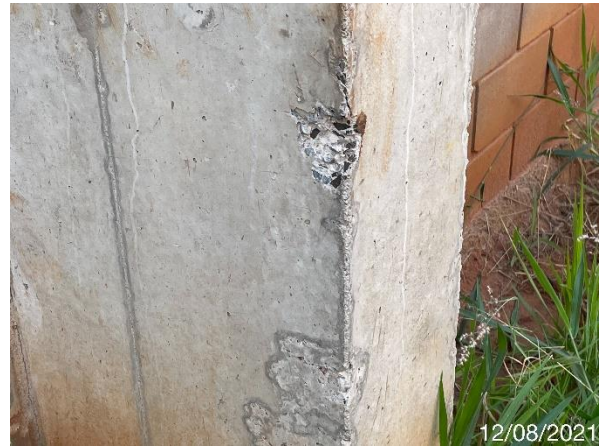
Foto 7.347: Estrutura danificada (Data da imagem: 12/08/2021)
