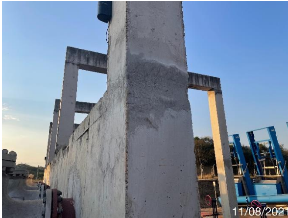
Foto 7.39: Superfície de concreto irregular e com presença de fissuras (Data da imagem: 11/08/2021)
