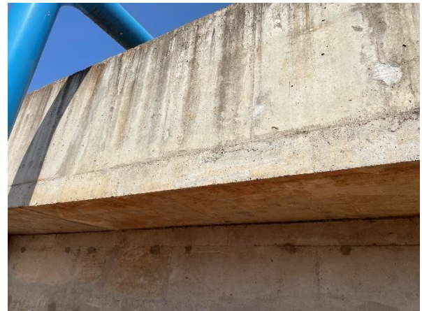
Foto 7.62: Superfície do concreto irregular (Data da imagem: 11/08/2021)
