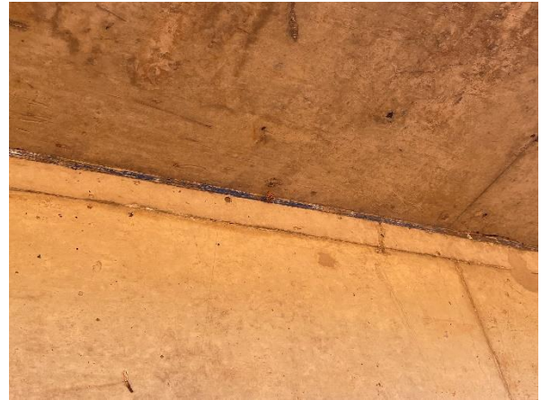
Foto 7.64: Marcas de formas na estrutura de concreto aparente e presença de vazios (Data da imagem: 11/08/2021)
