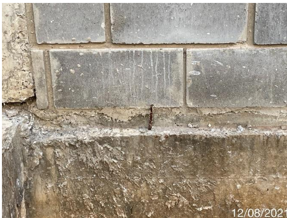
Foto 7.362: Ferragens na estrutura e respingos de concreto na estrutura (Data da imagem: 12/08/2021)
