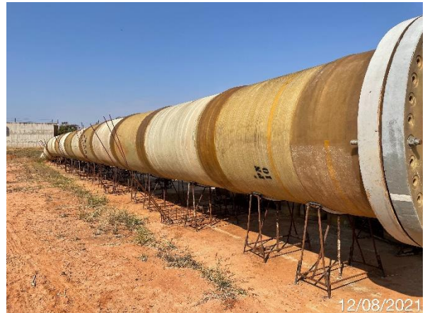
Foto 7.252: Ausência de berço de apoio da tubulação (Data da imagem: 12/08/2021)
