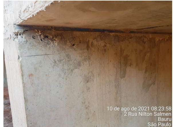
Foto 7.138: Estrutura danificada (Data da imagem: 10/08/2021)
