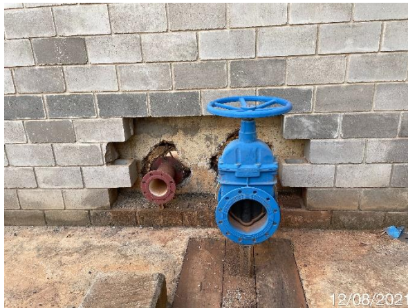
Foto 7.372: Alvenaria de blocos de concreto danificada, falta acabamento na alvenaria e na parede de concreto. (Data da imagem: 12/08/2021)
