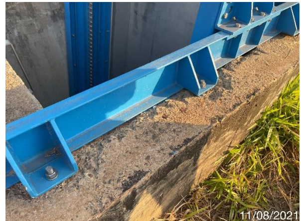
Foto 7.26: Superfície de concreto irregular (Data da imagem: 11/08/2021)
