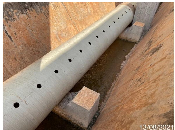
Foto 7.238: Estrutura do berço de apoio das tubulações danificados e tubos com assentamento invertido. (Data da imagem: 13/08/2021)
