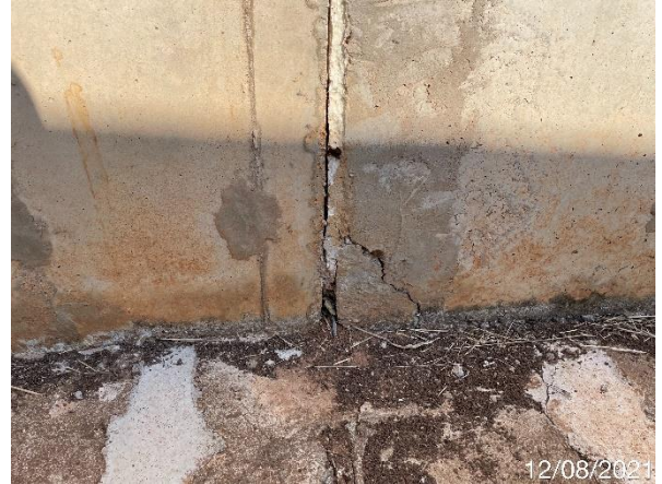
Foto 7.269: Estrutura de concreto danificada (Data da imagem: 12/08/2021)
