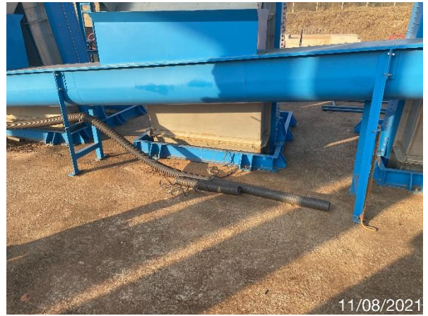
Foto 7.18: Tubo do equipamento de gradeamento danificado (Data da imagem: 11/08/2021)
