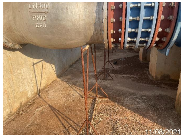
Foto 7.32: Ausência dos berços de apoio das tubulações (Data da imagem: 11/08/2021)
