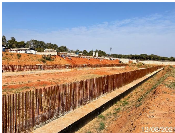
Foto 7.159: Aparência externa do Tanque de Aeração e Câmara Anóxica 2 e presença de ferragens
