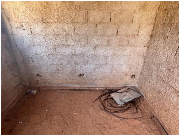
Foto 7.412: Blocos danificados (Data da imagem: 11/08/2021)
