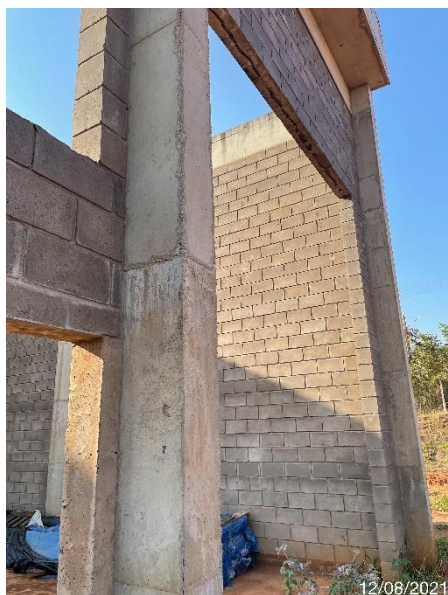
Foto 7.298: Superfície de concreto irregular com a presença de vazios de concretagem, bolhas e fissuras (Data da imagem: 12/08/2021)
