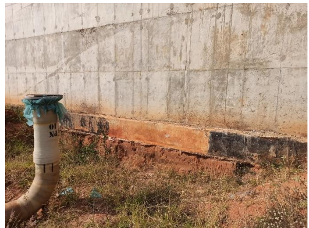
Foto 7.297: Ausência de impermeabilização e marcas de formas na estrutura de concreto aparente. (Data da imagem: 11/08/2021)
