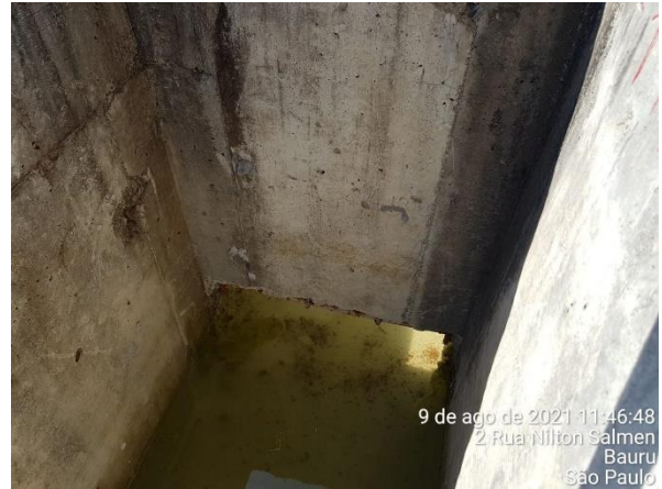
Foto 7.86: Superfície de concreto irregular, com acabamento incompleto na passagem da calha (Data da imagem: 09/08/2021)
