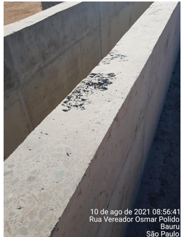
Foto 7.130: Superfície de concreto irregular e com vazios de concretagem (Data da imagem: 10/08/2021)
