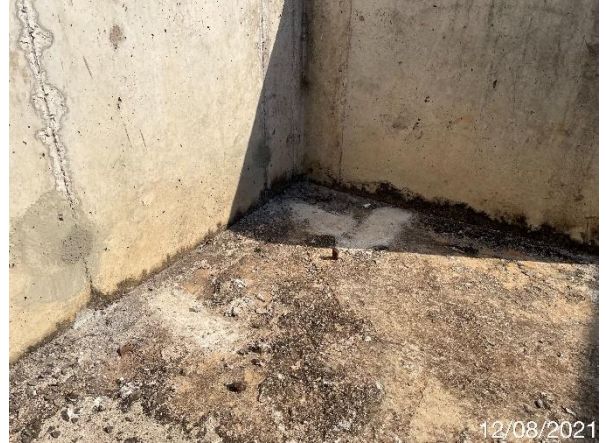
Foto 7.275: Superfície do concreto irregular com a presença de fissuras, marcas de formas no concreto e ferragem exposta (Data da imagem: 12/08/2021)
