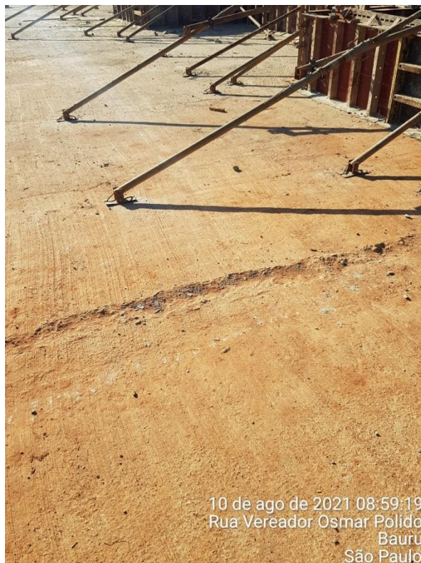
Foto 7.132: Irregularidade na superfície do concreto, fissuras e espaços vazios detectados (Data da imagem: 10/08/2021)
