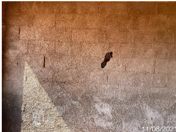
Foto 7.426: Alvenaria com blocos quebrados (Data da imagem: 11/08/2021)
