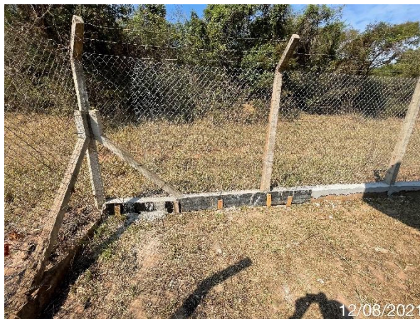
Foto 7.1: Presença de formas nas bases do mourão de concreto (Data da imagem: 12/08/2021)
