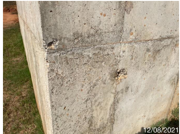
Foto 7.184: Superfície do concreto com irregularidades e estrutura danificada (Data da imagem: 12/08/2021)
