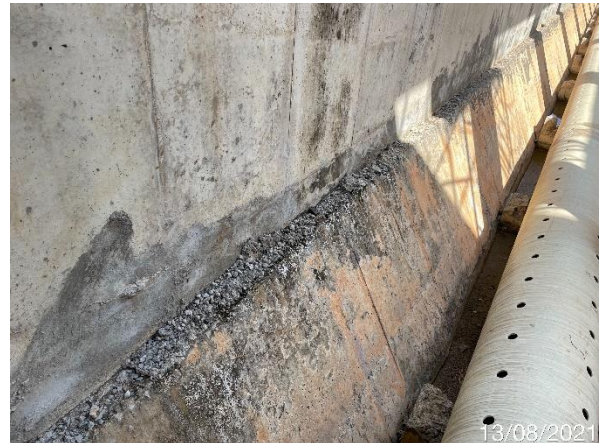
Foto 7.212: Estruturas divisórias incompletas e com marcas de forma no concreto (Data da imagem: 13/08/2021)
