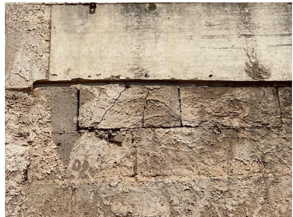
Foto 7.407: Blocos de concreto danificados e presença de núcleo perdido (Data da imagem: 11/08/2021)
