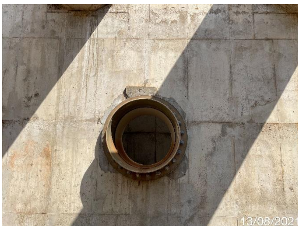
Foto 7.237: Superfície do concreto irregular, estrutura danificada e ausência de tubulação (Data da imagem: 13/08/2021)
