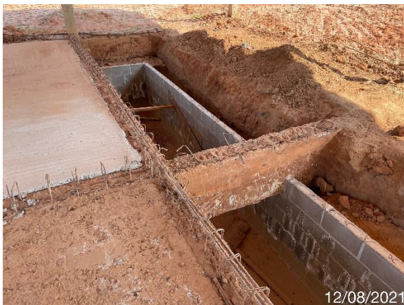
Foto 7.460: Ferragens da viga baldrame exposta sem proteção e danificada (Data da imagem: 12/08/2021)
