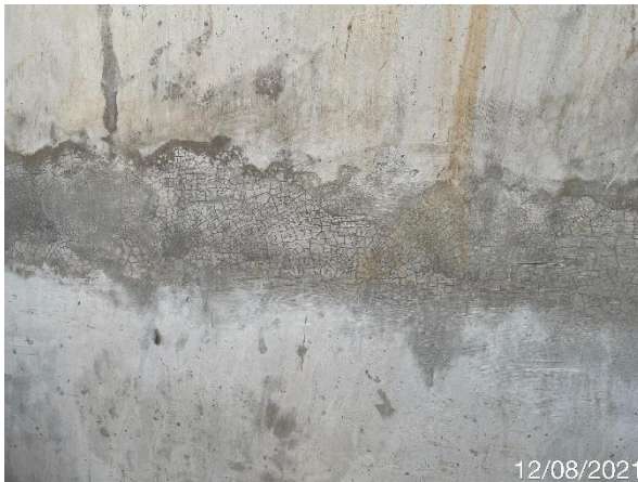
Foto 7.318: Superfície de concreto irregular e presença de vazios de concretagem e bolhas (Data da imagem: 12/08/2021)
