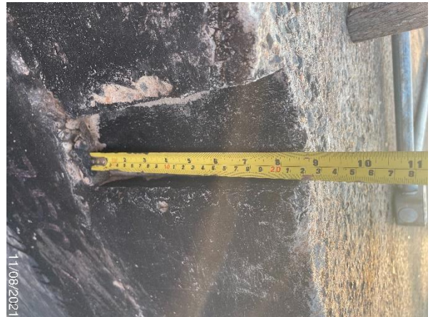
Foto 7.20: Detalhe não previsto em projeto (Data da imagem: 11/08/2021)
