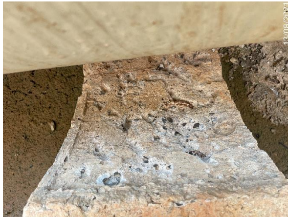
Foto 7.229: Folga no berço de apoio das tubulações, presença de ferragem (Data da imagem: 13/08/2021)
