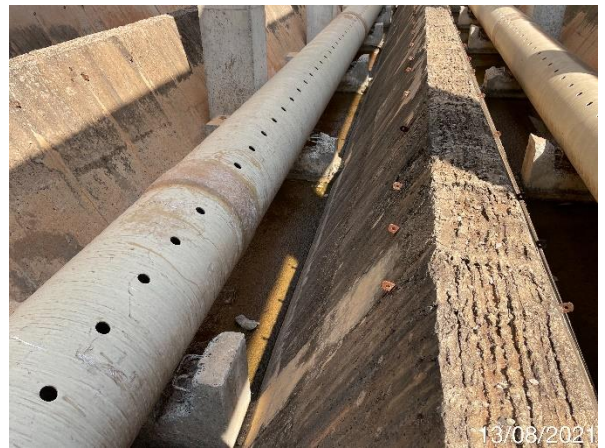
Foto 7.224: Berço de apoio das tubulações danificados e estruturas divisórias incompletas (Data da imagem: 13/08/2021)
