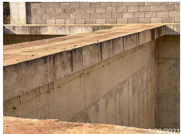
Foto 7.329: Presença de núcleos perdidos (Data da imagem: 12/08/2021)
