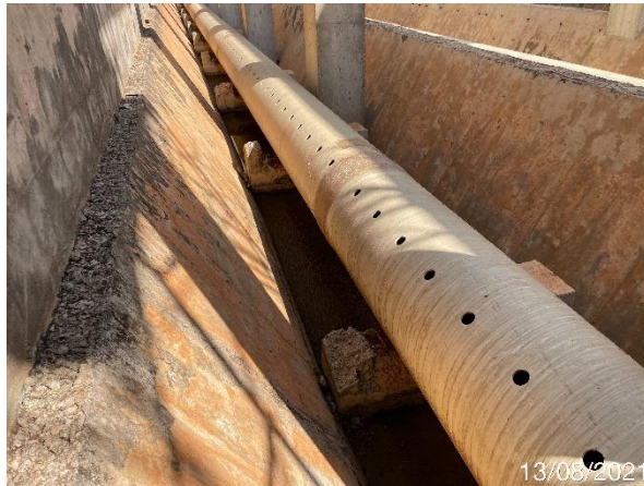
Foto 7.209: Berço de apoio das tubulações danificados, estruturas divisórias incompletas montagem dos tubos invertida. (Data da imagem: 13/08/2021)
