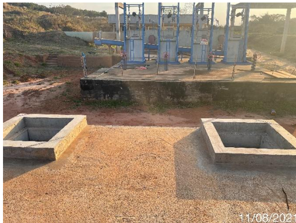
Foto 7.9: Abertura de inspeção sem instalação de tampa (Data da imagem: 11/08/2021)
