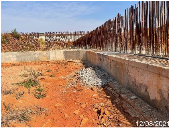
Foto 7.163: Ausência de impermeabilização interna, superfície do concreto com marcas de formas e presença de resíduos no interior do tanque (Data da imagem: 12/08/2021)
