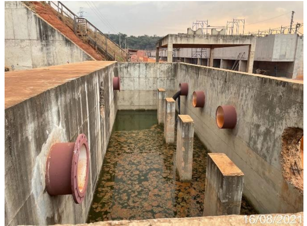
Foto 7.120: Aparência interna da Estação Elevatória de Lodo (Data da imagem: 16/08/2021)
