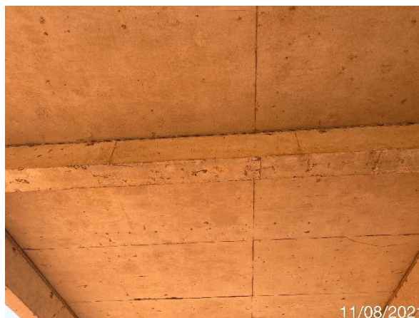
Foto 7.455: Marcas de forma no concreto, com presença de fissuras, vazios de concretagem e núcleos perdidos (Data da imagem: 11/08/2021)
