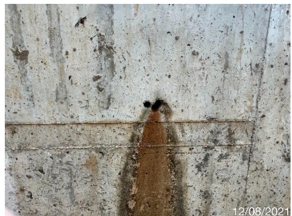
Foto 7.369: Superfície de concreto irregular e presença de vazios de concretagem (Data da imagem: 12/08/2021)
