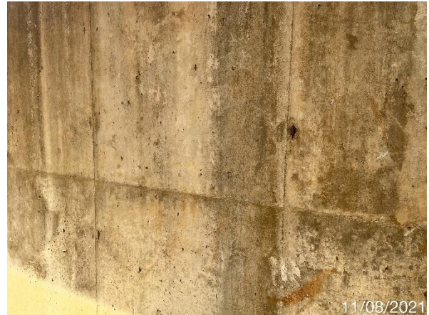
Foto 7.30: Superfície de concreto irregular, com marcas das formas e vazios de concretagem (Data da imagem: 11/08/2021)
