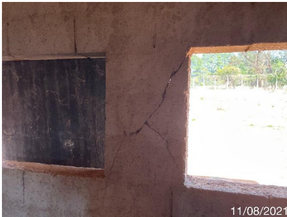
Foto 7.432: Alvenaria trincada (Data da imagem: 11/08/2021)
