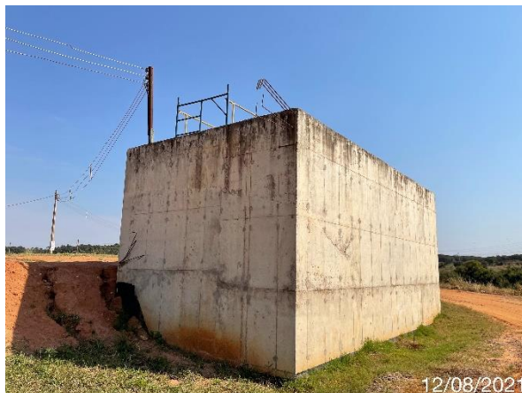
Foto 7.181: Aparência externa do CP03, presença de ferragem exposta sem proteção adequada e com marcas de forma na superfície do concreto (Data da imagem: 12/08/2021)
