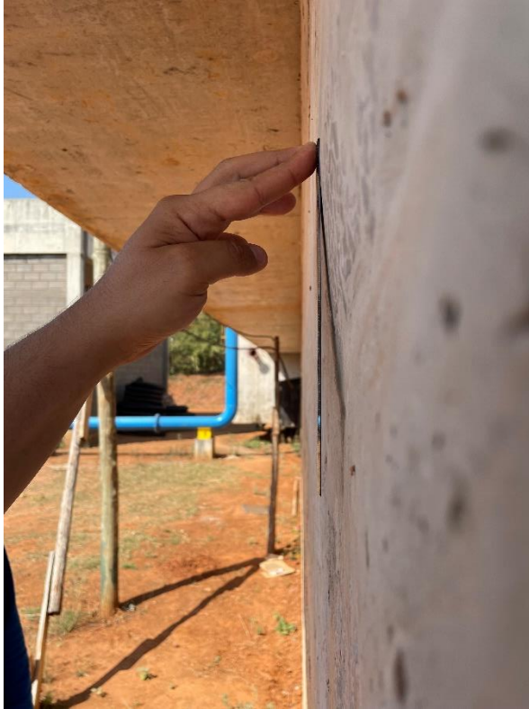
Foto 7.55: Superfície do concreto irregular (Data da imagem: 11/08/2021)
