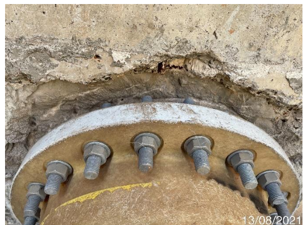
Foto 7.220: Estrutura sem acabamento e com ferragem exposta (Data da imagem: 13/08/2021)
