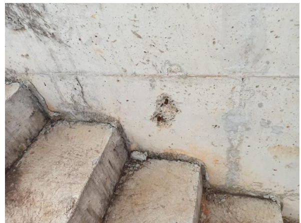
Foto 7.291: Vazios de concretagem, arestas e superfícies danificadas (Data da imagem: 11/08/2021)
