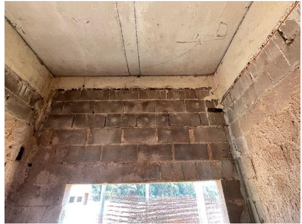
Foto 7.411: Formas de madeira nas vigas, ausência de chapisco e blocos danificados (Data da imagem: 11/08/2021)
