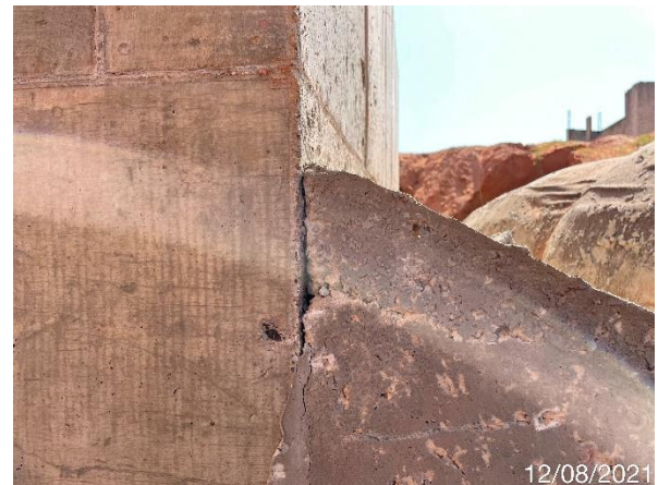
Foto 7.52: Presença de fissuras e marca de formas no concreto (Data da imagem: 12/08/2021)
