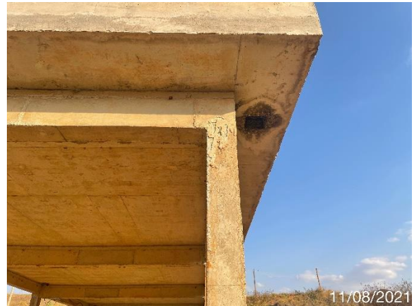
Foto 7.447: Superfície do concreto com irregularidades, presença de vazios de concretagem, bolhas, infiltração e fissuras (Data da imagem: 11/08/2021)
