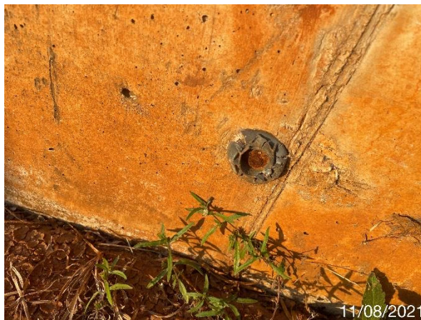
Foto 7.11: Presença de vazios de concretagem e de núcleos perdidos (Data da imagem: 11/08/2021)
