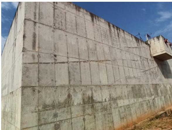
Foto 7.296: Marcas de formas na estrutura de concreto aparente, presença fissuras, trincas e superfícies irregulares; (Data da imagem: 11/08/2021)
