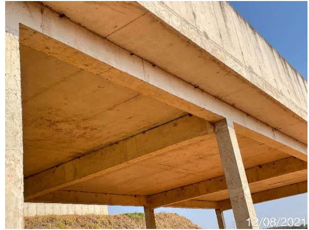
Foto 7.467: Presença de fissuras, núcleos perdidos e marca de forma no concreto (Data da imagem: 12/08/2021)
