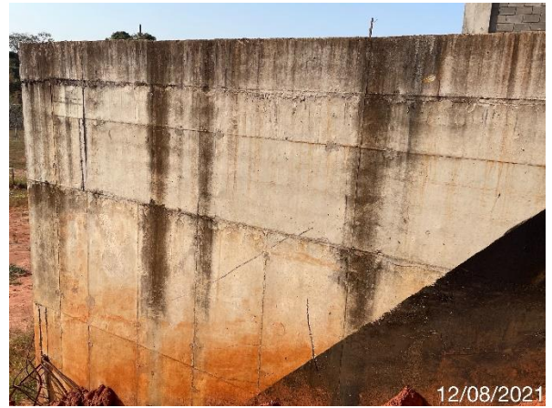
Foto 7.331: Superfície do concreto com irregularidades e fissuras (Data da imagem: 12/08/2021)
