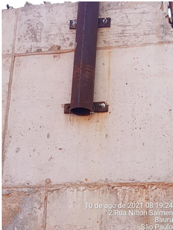
Foto 7.135: Marcas de formas na estrutura de concreto aparente e presença de parafusos na estrutura (Data da imagem: 10/08/2021)
