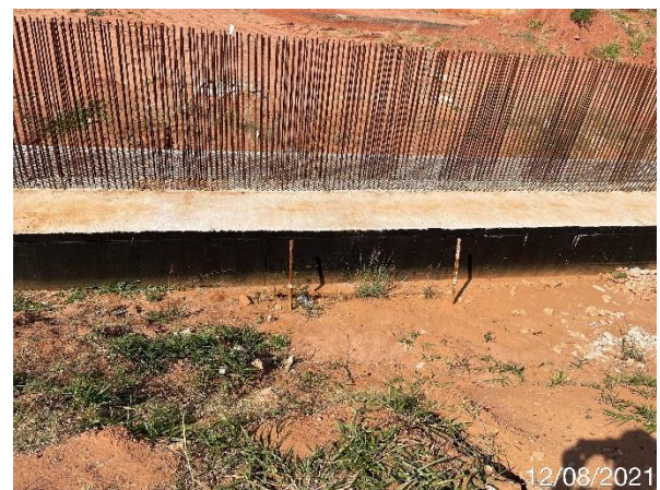
Foto 7.160: Ferragens expostas sem proteção adequada (Data da imagem: 12/08/2021)
