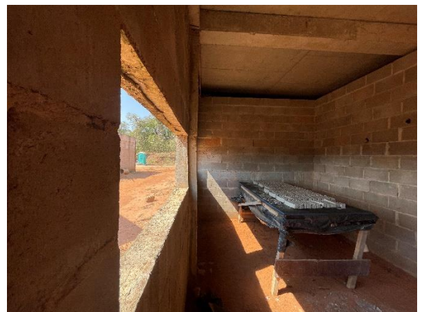
Foto 7.435: Serviço de requadro danificado (Data da imagem: 11/08/2021)
