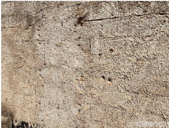
Foto 7.486: Blocos de concreto danificados (Data da imagem: 12/08/2021)
