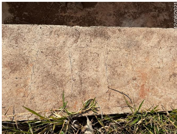
Foto 7.264: Presença de fissuras nas paredes de concreto (Data da imagem: 12/08/2021)
