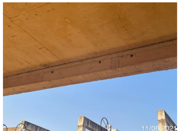
Foto 7.451: Presença de núcleos perdidos e marcas de forma no concreto (Data da imagem: 11/08/2021)
