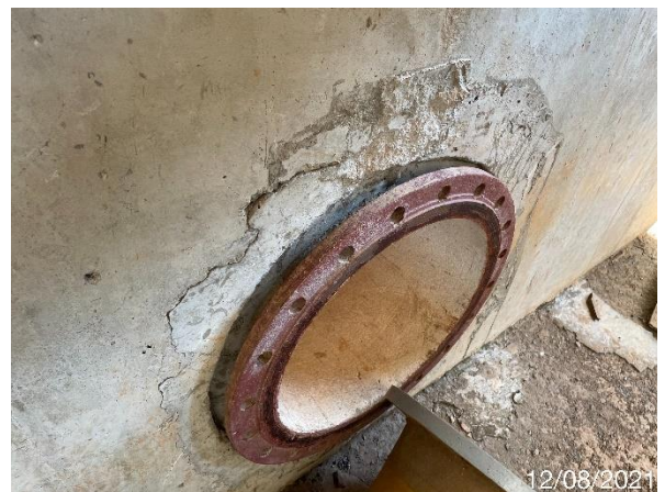
Foto 7.190: Superfície do concreto irregular, com presença de fissuras e trincas (Data da imagem: 12/08/2021)
