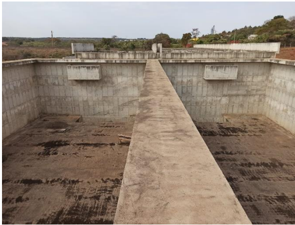
Foto 7.292: - Marcas de formas na estrutura de concreto aparente, presença de vazios de concretagem, fissuras, bolhas, trincas e superfícies irregulares. (Data da imagem: 11/08/2021)
