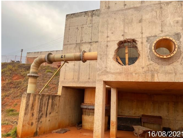
Foto 7.119: Superfície do concreto com irregularidades, marcas das formas e ferragens expostas (Data da imagem: 16/08/2021)
