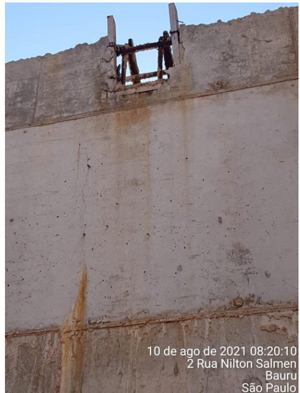
Foto 7.136: Vazios de concretagem e marcas de formas na estrutura de concreto aparente (Data da imagem: 10/08/2021)
