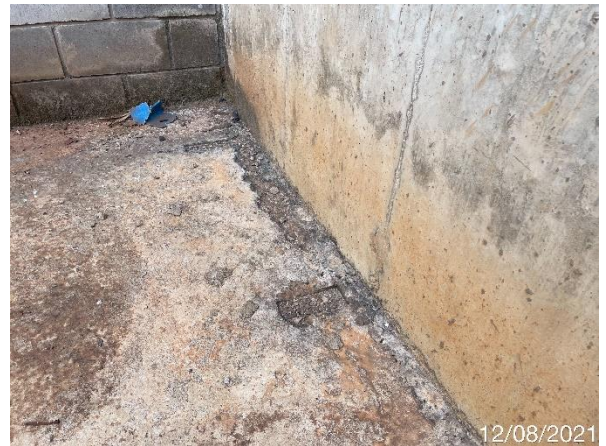
Foto 7.373: Superfície de concreto da laje irregular com ferragens expostas (Data da imagem: 12/08/2021)
