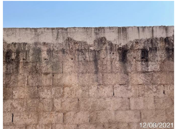
Foto 7.493: Blocos de concreto danificados (Data da imagem: 12/08/2021)
