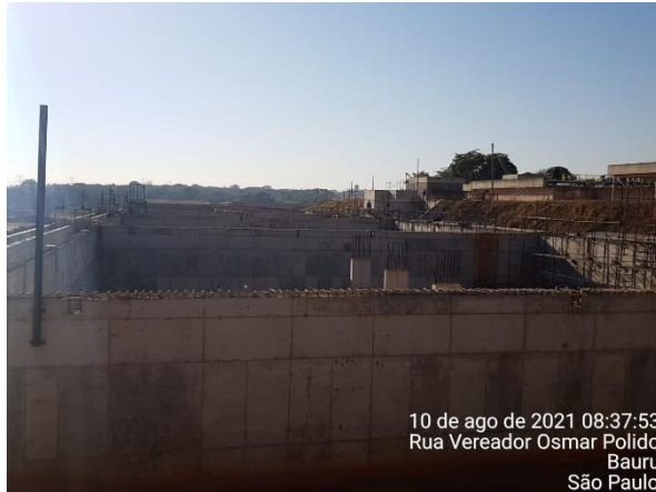
Foto 7.137: Não foi possível acessar o interior da estrutura. (Data da imagem: 10/08/2021)
