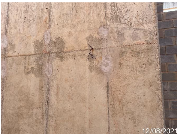
Foto 7.344: Superfície de concreto irregular, presença de ferragens expostas e marcas de forma no concreto(Data da imagem: 12/08/2021)
