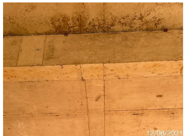
Foto 7.471: Presença de fissuras, núcleos perdidos, infiltração e marca de forma no concreto (Data da imagem: 12/08/2021)
