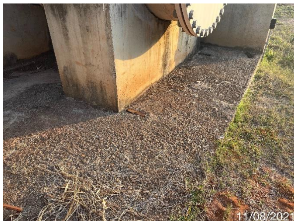
Foto 7.45: Presença de taliscas de madeira (Data da imagem: 11/08/2021)
