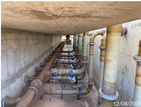
Foto 7.187: Ausência dos berços de apoio das tubulações (Data da imagem: 12/08/2021)
