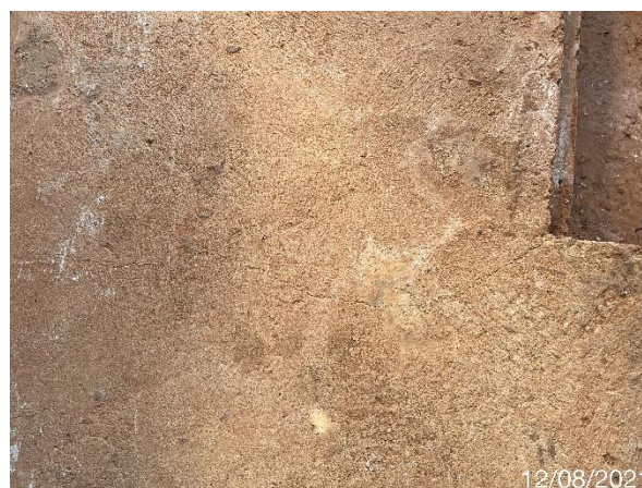
Foto 7.174: Fissuras na laje próxima aos vértices das canaletas (Data da imagem: 12/08/2021)
