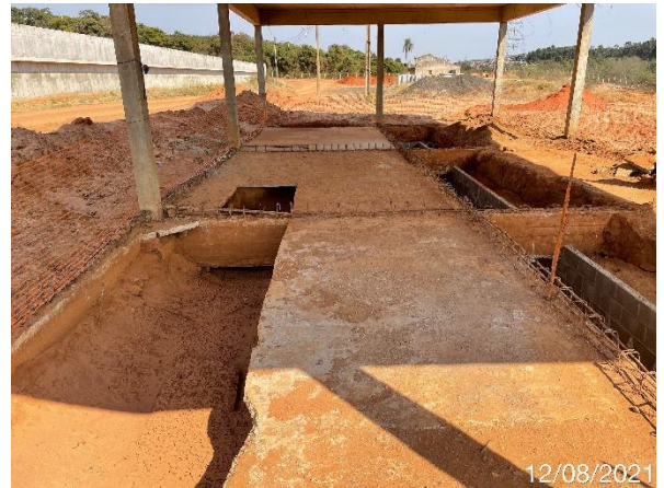
Foto 7.459: Ferragens da viga baldrame exposta sem proteção e ausência de impermeabilização na viga baldrame (Data da imagem: 12/08/2021)
