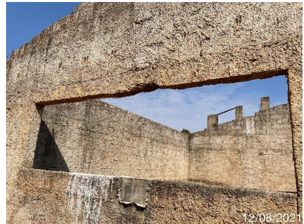
Foto 7.483: Estrutura danificada (Data da imagem: 12/08/2021)
