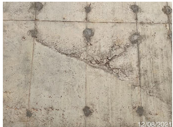
Foto 7.182: Superfície irregular do concreto, com presença de vazios de concretagem e bolhas (Data da imagem: 12/08/2021)
