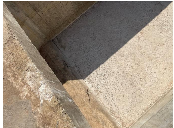
Foto 7.82: Execução do enchimento incompleto e presença ferragens expostas (Data da imagem: 11/08/2021)
