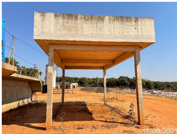
Foto 7.452: Aparência da subestação elétrica SE-03/04 (Data da imagem: 11/08/2021)
