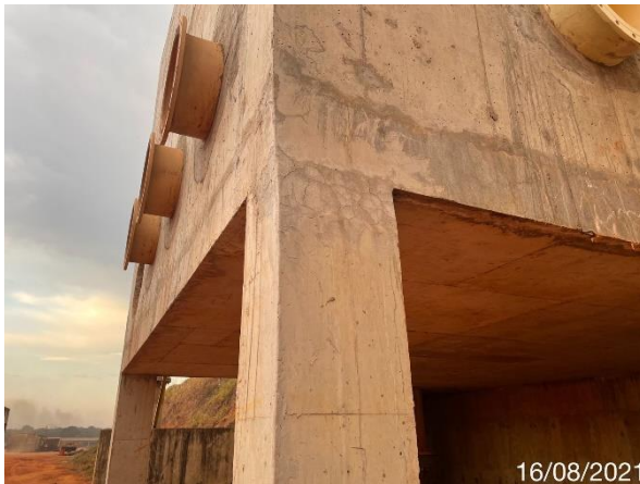
Foto 7.121: Superfície do concreto com irregularidades, marcas das formas e fissuras (Data da imagem: 16/08/2021)
