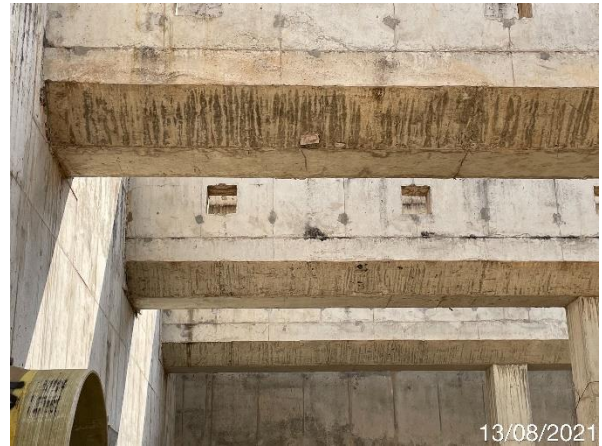
Foto 7.234: Superfície do concreto irregular, com marcas de formas no concreto, presença de fissuras e taliscas de madeira (Data da imagem: 13/08/2021)
