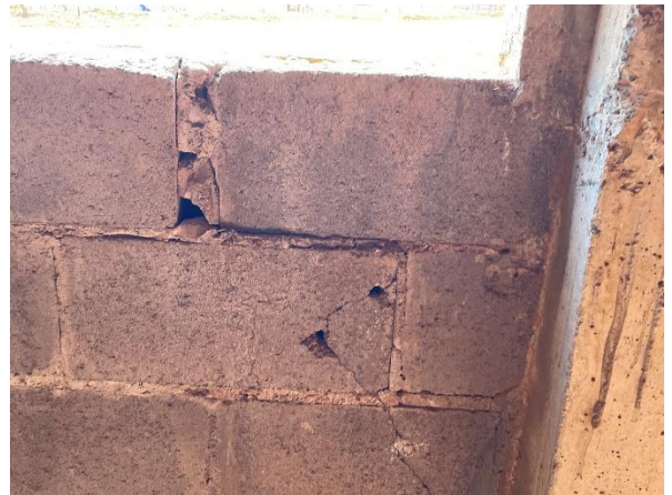
Foto 7.441: Blocos de concreto trincados (Data da imagem: 11/08/2021)
