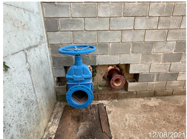
Foto 7.367: Alvenaria de blocos de concreto danificada (falta acabamento) (Data da imagem: 12/08/2021)
