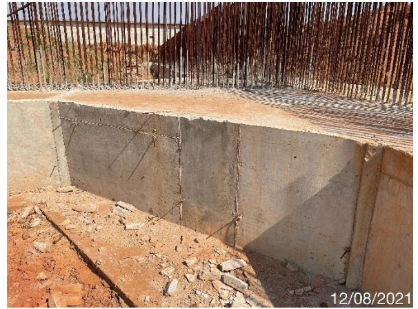
Foto 7.164: Superfície do concreto irregular com marcas de formas e presença de núcleos perdidos (Data da imagem: 12/08/2021)
