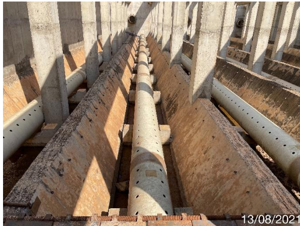
Foto 7.239: Estruturas divisórias incompletas, presença de núcleos perdidos, presença de fissuras nos pilares e marcas de forma no concreto (Data da imagem: 13/08/2021)
