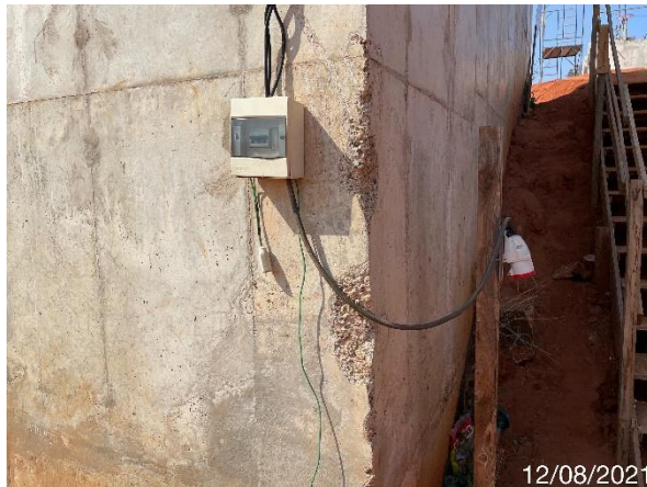
Foto 7.149: Arestas das paredes danificadas (Data da imagem: 12/08/2021)
