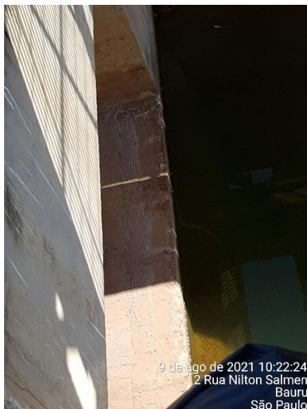
Foto 7.89: Trincas na laje de concreto (Data da imagem: 09/08/2021)
