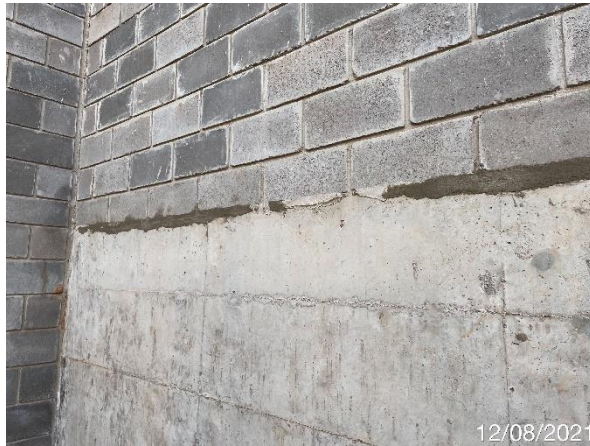
Foto 7.370: Superfície de concreto irregular e fissuras nos reparos realizados (Data da imagem: 12/08/2021)
