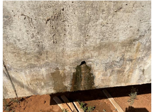
Foto 7.60: Presença de vazio com necessidade de reparos (Data da imagem: 11/08/2021)
