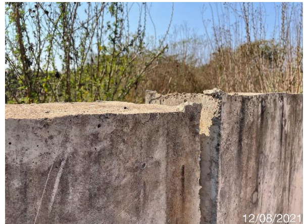
Foto 7.285: Não foi executado as juntas de dilatação (Data da imagem: 12/08/2021)
