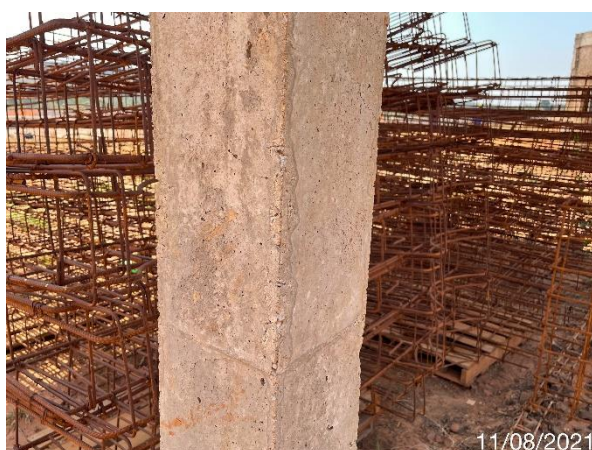
Foto 7.478: Presença de vazios de concretagem, bolhas e fissuras nos pilares (Data da imagem: 11/08/2021)
