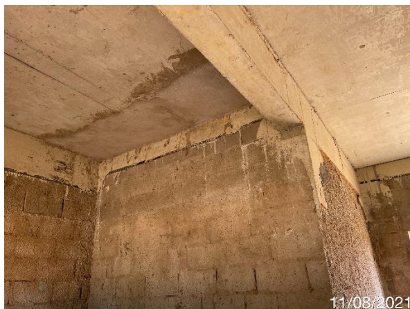
Foto 7.414: Formas de madeira nas vigas e ausência de chapisco (Data da imagem: 11/08/2021)
