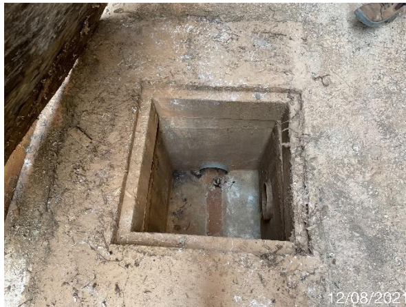
Foto 7.193: Ausência das tampas das caixas (Data da imagem: 12/08/2021)
