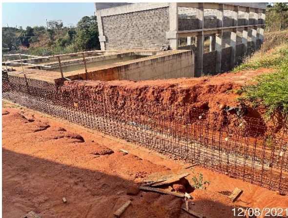
Foto 7.324: Ferragens expostas sem proteção (Data da imagem: 12/08/2021)
