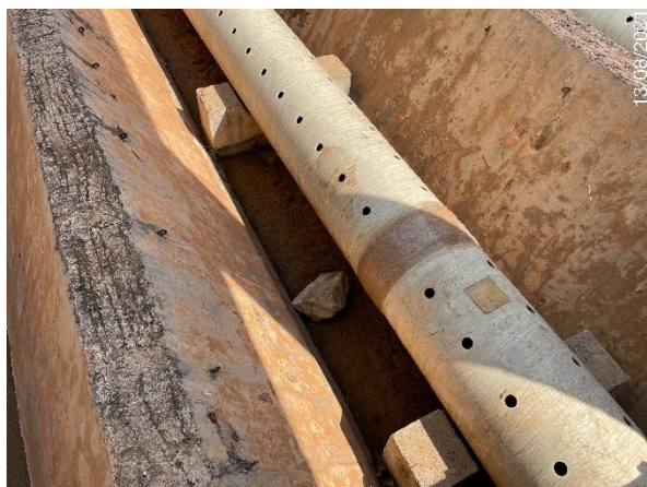
Foto 7.243: Estruturas divisórias incompletas, presença de núcleos perdidos e resíduos da construção (Data da imagem: 13/08/2021)
