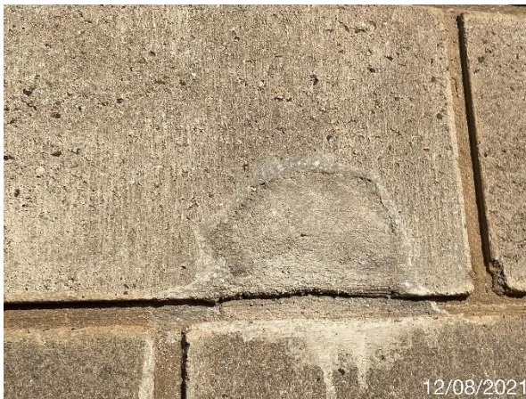
Foto 7.304: Reparos realizados apresentando fissuras (Data da imagem: 12/08/2021)
