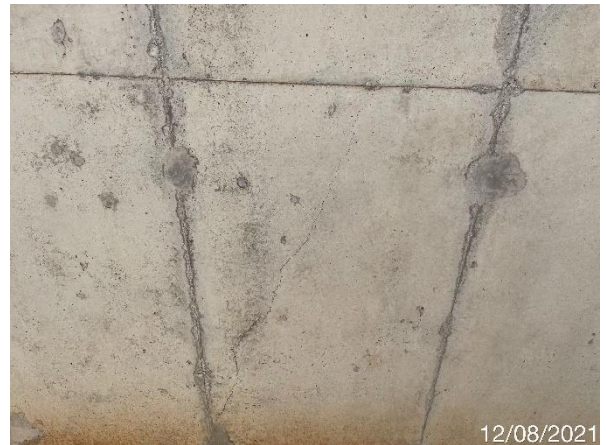
Foto 7.271: Superfície do concreto irregular com a presença de fissuras e marcas de formas no concreto (Data da imagem: 12/08/2021)
