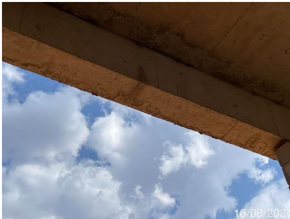
Foto 7.105: Presença de fissuras na viga de concreto (Data da imagem: 16/08/2021)
