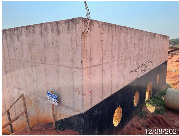
Foto 7.143: Aparência externa do CP02 com a presença de ferragens expostas sem proteção adequada (Data da imagem: 12/08/2021)
