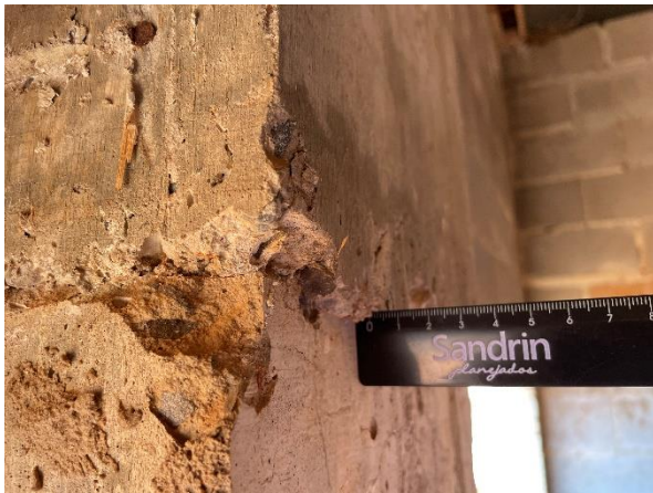
Foto 7.440: Superfície de concreto irregular (Data da imagem: 11/08/2021)
