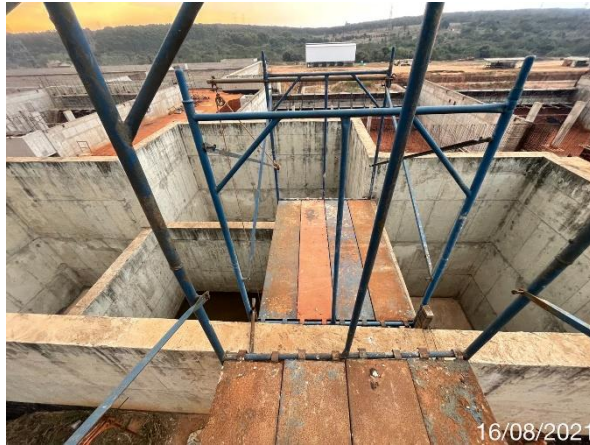
Foto 7.125: Aparência interna da Caixa de Distribuição 01, marcas de formas (Data da imagem: 16/08/2021)
