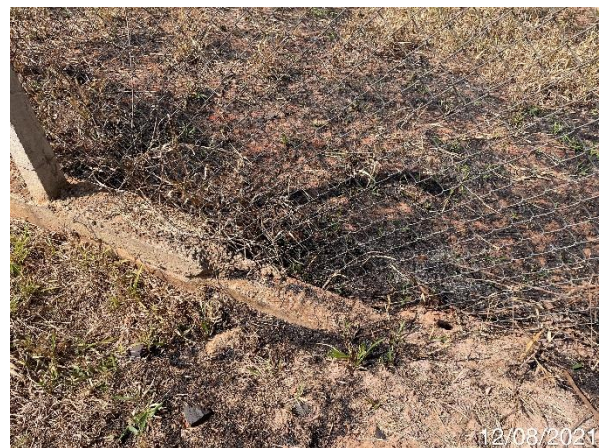
Foto 7.4: Base danificada (Data da imagem: 12/08/2021)
