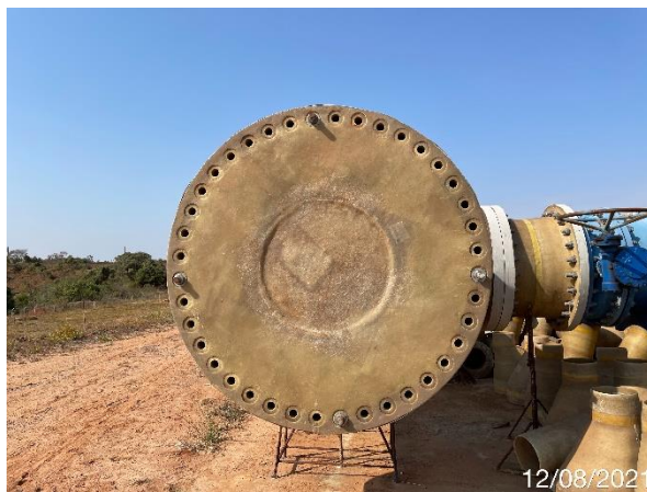
Foto 7.253: Ausência de parafusos na flange cega (Data da imagem: 12/08/2021)
