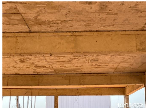
Foto 7.461: Marcas de forma no concreto e presença de fissuras por toda a laje e viga (Data da imagem: 12/08/2021)
