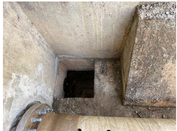
Foto 7.210: Superfície do concreto irregular, com presença de taliscas de madeiras e estruturas divisórias incompletas (Data da imagem: 13/08/2021)
