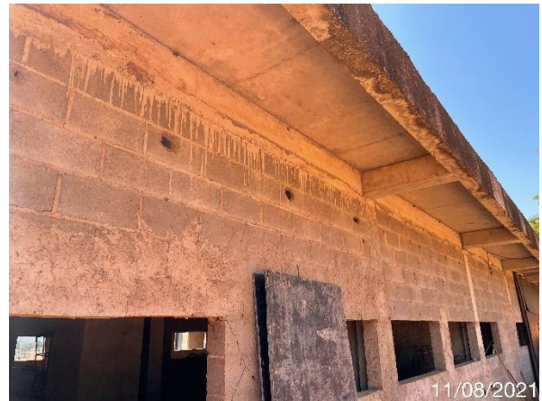
Foto 7.421 Aparência externa do edifício, serviço de chapisco incompleto, presença de blocos quebrados e núcleos perdidos (Data da imagem: 11/08/2021)
