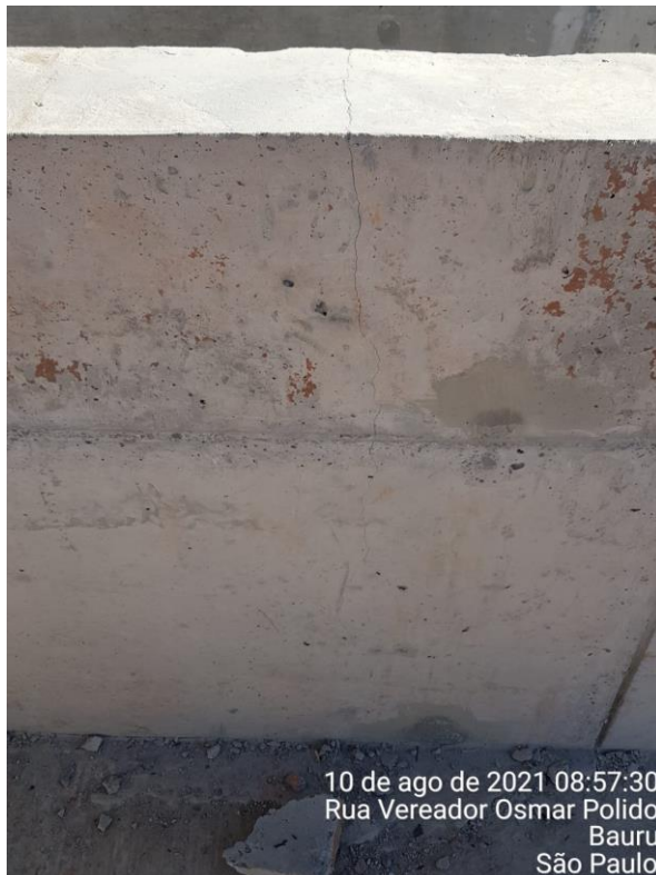
Foto 7.129 Presença de vazios de concretagem e fissuras (Data da imagem: 10/08/2021)
