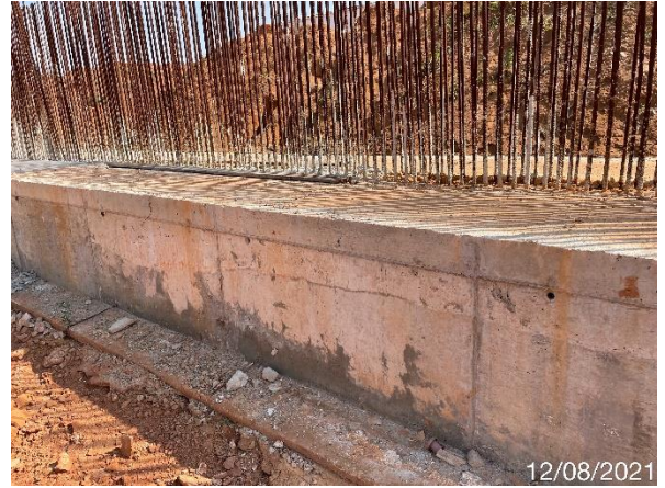
Foto 7.166: Superfície do concreto irregular com marcas de formas e presença de núcleos perdidos (Data da imagem: 12/08/2021)
