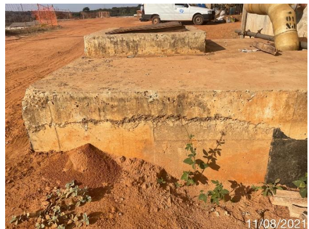
Foto 7.94: Vazios de concretagem (Data da imagem: 11/08/2021)
