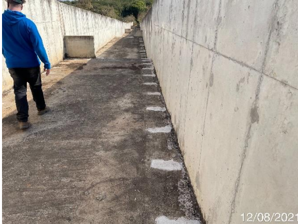
Foto 7.274: Marcas de forma no concreto (Data da imagem: 12/08/2021)
