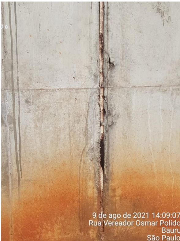
Foto 7.153: Marcas de formas na estrutura de concreto aparente e com presença de fissuras (Data da imagem: 09/08/2021)
