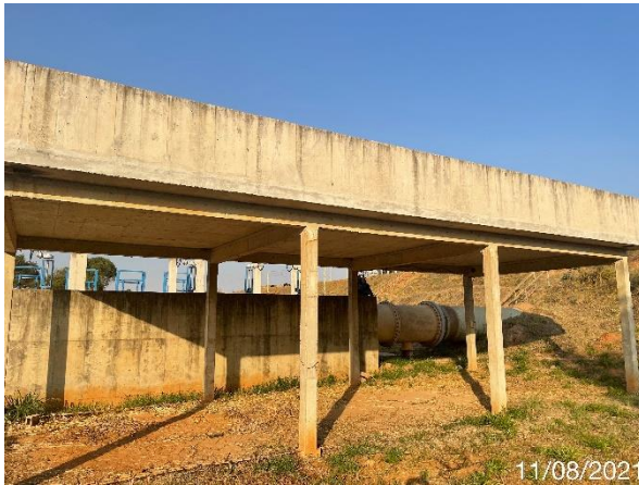
Foto 7.446: Aparência da subestação elétrica, com fissuras por toda a laje e viga (Data da imagem: 11/08/2021)
