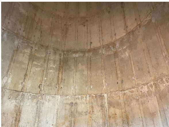
Foto 7.402: Marca de forma no concreto, (execução com forma inadequada) (Data da imagem: 11/08/2021)
