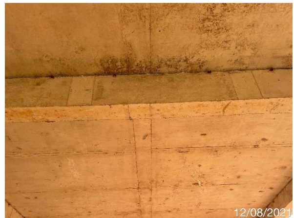
Foto 7.469: Presença de fissuras, núcleos perdidos e marca de forma no concreto (Data da imagem: 12/08/2021)
