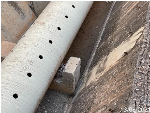
Foto 7.221: Berço de apoio das tubulações danificados e estruturas divisórias incompletas (Data da imagem: 13/08/2021)
