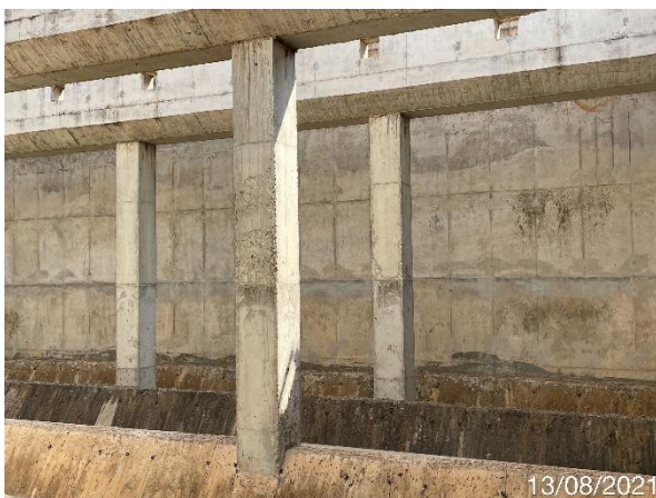
Foto 7.225: Superfície do concreto irregular com presença de vazios de concretagem (Data da imagem: 13/08/2021)
