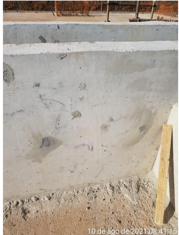
Foto 7.142: Presença de vazios de concretagem, bolhas e fissuras nos reparos realizados na superfície (Data da imagem: 10/08/2021)
