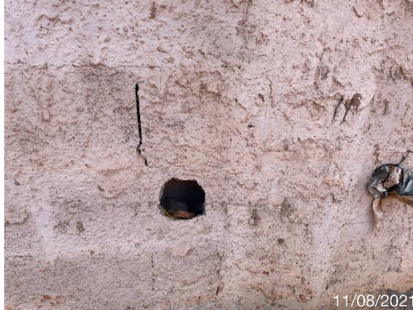
Foto 7.424: Alvenaria com blocos quebrados (Data da imagem: 11/08/2021)
