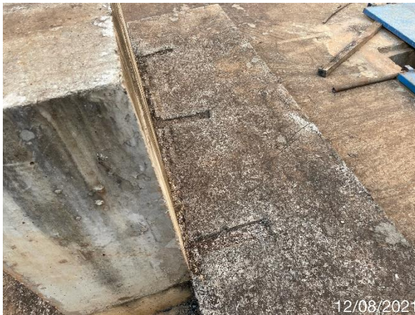
Foto 7.354: Superfície de concreto irregular (Data da imagem: 12/08/2021)
