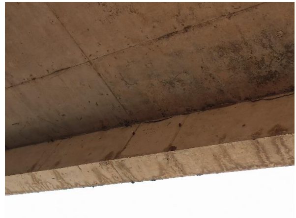
Foto 7.106: Presença de fissuras nas vigas e núcleos perdidos (Data da imagem: 16/08/2021)
