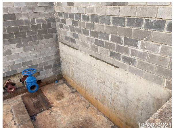
Foto 7.357: Estrutura da alvenaria danificada (Data da imagem: 12/08/2021)
