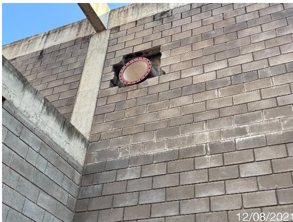
Foto 7.312: Estrutura sem acabamento. (Data da imagem: 12/08/2021)
