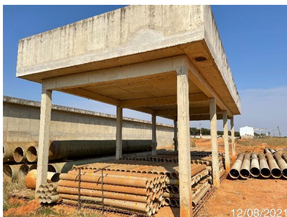
Foto 7.462: Aparência da subestação SE-6/7/8 e estocagem dos tubos (Data da imagem: 12/08/2021)
