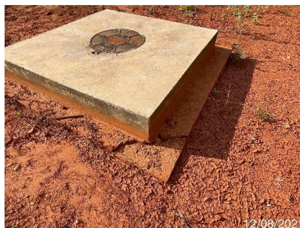
Foto 7.377: Poço de visita danificado (Data da imagem: 12/08/2021)
