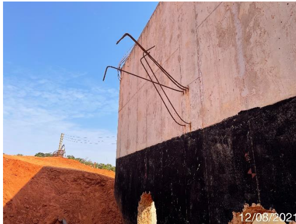
Foto 7.147: Ferragens expostas sem proteção adequada, com marcas de formas na estrutura de concreto e presença de vazios de concretagem (Data da imagem: 12/08/2021)
