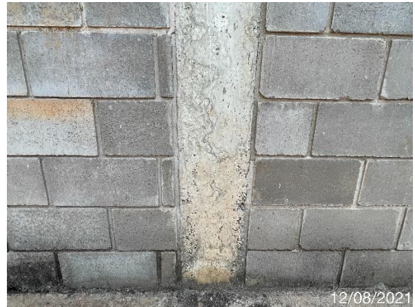
Foto 7.365: Superfície de concreto irregular, presença de fissuras e vazios de concretagem (Data da imagem: 12/08/2021)
