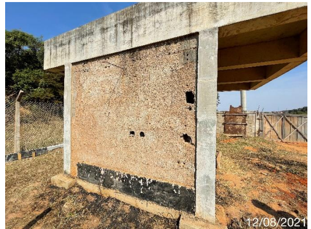
Foto 7.379: Alvenaria danificada e impermeabilização incompleta (Data da imagem: 12/08/2021)
