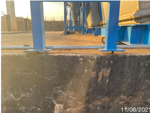
Foto 7.23 Irregularidade na superfície do concreto e equipamento não apoiado adequadamente (Data da imagem: 11/08/2021)
