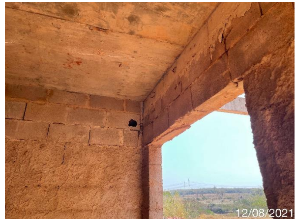
Foto 7.495: Blocos de concreto quebrados e ausência de chapisco (Data da imagem: 12/08/2021)
