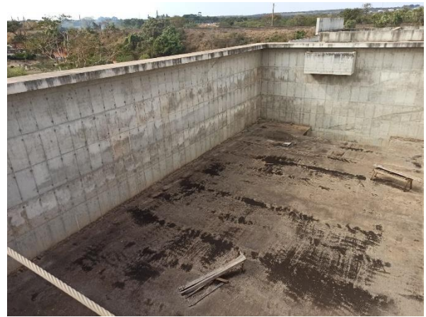
Foto 7.293: : Marcas de formas na estrutura de concreto aparente e presença de resíduos de construção (Data da imagem: 11/08/2021)
