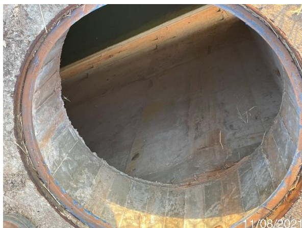
Foto 7.15: Presença de Núcleos Perdidos (Data da imagem: 11/08/2021)
