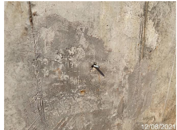
Foto 7.150: Presença de parafusos na estrutura de concreto (Data da imagem: 12/08/2021)
