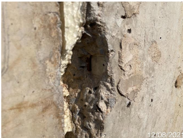
Foto 7.278: Estrutura de concreto danificada (Data da imagem: 12/08/2021)
