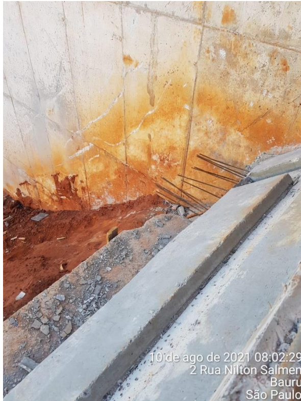
Foto 7.141: Presença de resíduos do processo de concretagem e ferragens exposta na estrutura e ausência da canaleta (Data da imagem: 10/08/2021)
