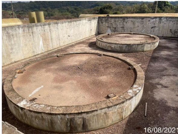
Foto 7.177: Presença de forma de madeira, fissuras no concreto e fungos (Data da imagem: 16/08/2021)
