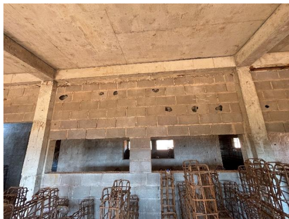
Foto 7.443: Blocos de concreto quebrados, com marcas de formas no concreto e presença de formas de madeira (Data da imagem: 11/08/2021)
