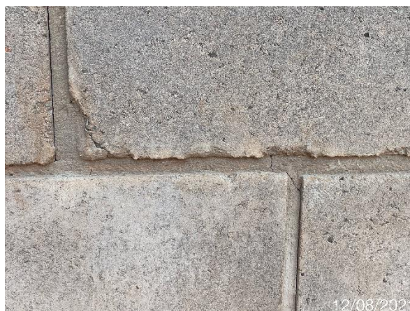
Foto 7.301: Fissuras nos blocos de concreto (Data da imagem: 12/08/2021)
