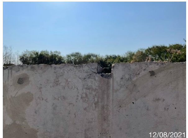
Foto 7.279: Estrutura de concreto danificada (Data da imagem: 12/08/2021)
