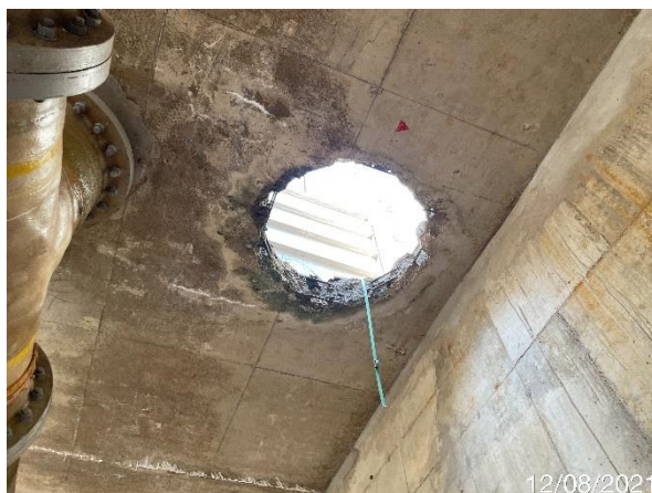
Foto 7.195: Presença de fungos na laje (Data da imagem: 12/08/2021)
