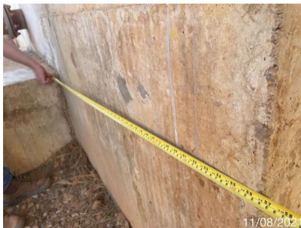
Foto 7.99: Caixa executada com medidas que diferem do projeto (Data da imagem: 11/08/2021)
