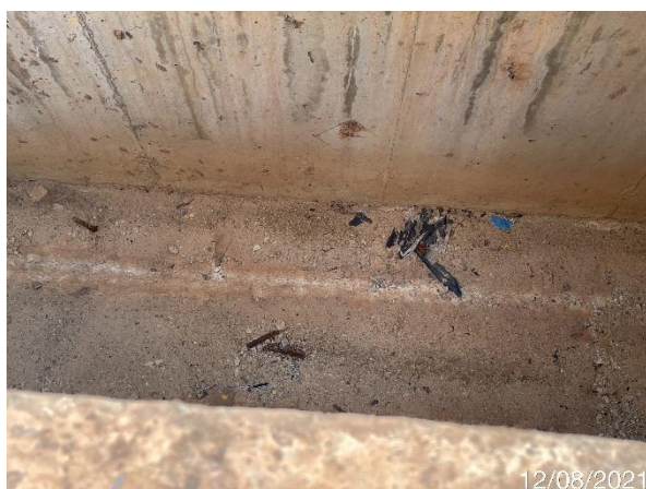
Foto 7.376: Presença de fissuras e (Data da imagem: 12/08/2021)
