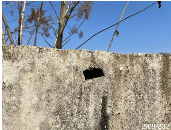
Foto 7.282: Estrutura de concreto danificada (Data da imagem: 12/08/2021)
