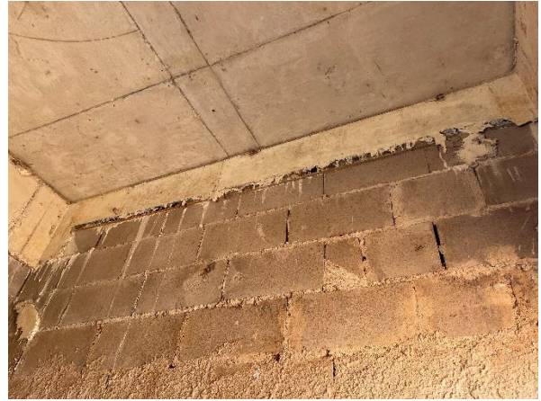
Foto 7.409: Formas de madeira nas vigas e ausência de chapisco (Data da imagem: 11/08/2021)
