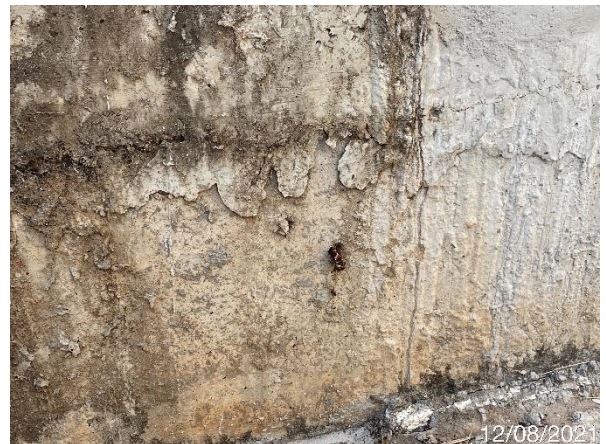
Foto 7.273: Superfície do concreto irregular e presença de ferragem exposta (Data da imagem: 12/08/2021)
