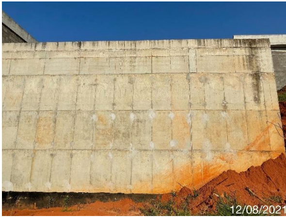
Foto 7.330: Marcas de forma no concreto (Data da imagem: 12/08/2021)
