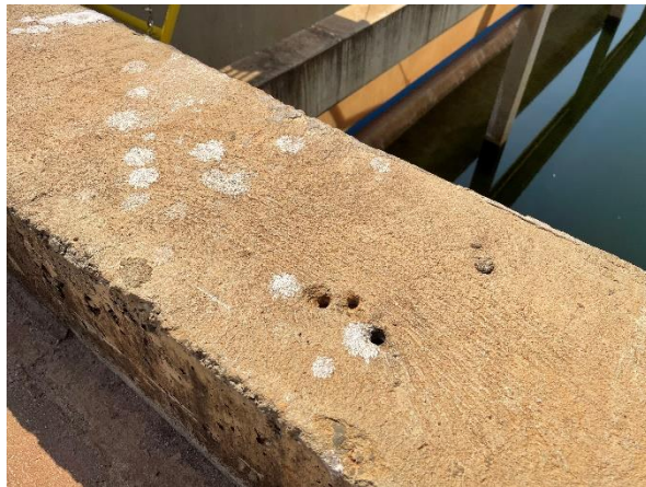
Foto 7.87: Superfície de concreto com presença de furos que necessitam de reparos (Data da imagem: 11/08/2021)
