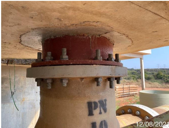
Foto 7.203: Ausência de parafuso e superfície do concreto irregular (Data da imagem: 12/08/2021)
