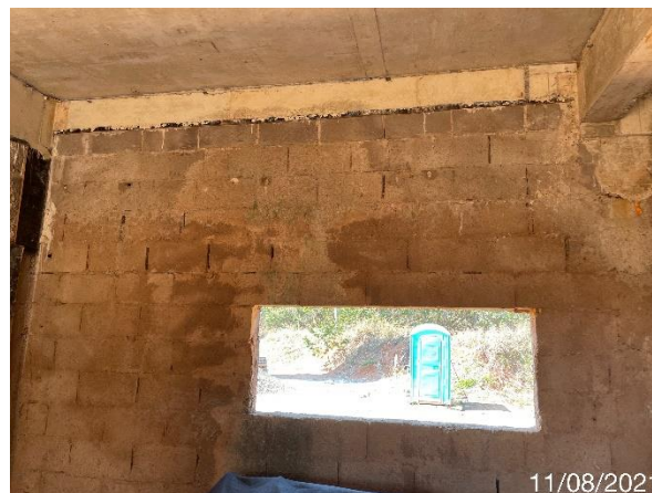
Foto 7.415: Formas de madeira nas vigas e ausência de chapisco (Data da imagem: 11/08/2021)
