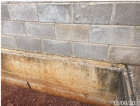
Foto 7.348: Presença de fissuras no concreto (Data da imagem: 12/08/2021)
