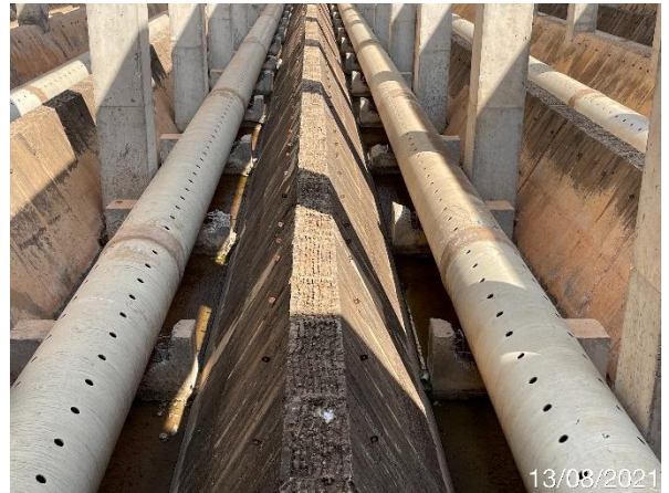
Foto 7.222: Berço de apoio das tubulações danificados e estruturas divisórias incompletas (Data da imagem: 13/08/2021)
