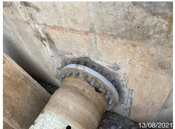
Foto 7.218: Superfície do concreto irregular, presença de vazios de concretagem, bolhas e estrutura danificada (Data da imagem: 13/08/2021)
