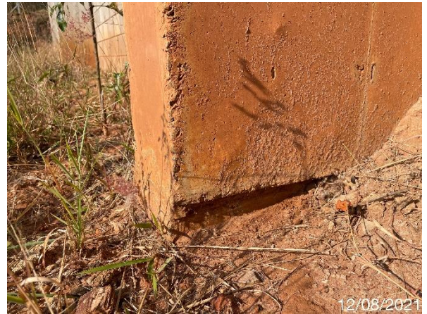
Foto 7.341: Superfície de concreto irregular (Data da imagem: 12/08/2021)
