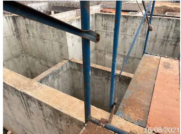
Foto 7.126: Superfície de concreto irregular, marcas das formas e vazios de concretagem (Data da imagem: 16/08/2021)
