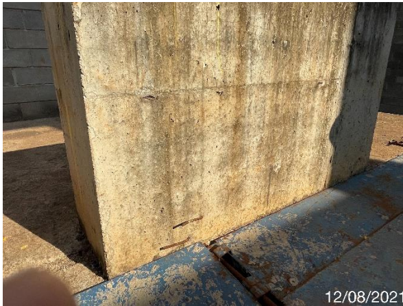
Foto 7.364: Superfície de concreto irregular e ferragens expostas (Data da imagem: 12/08/2021)
