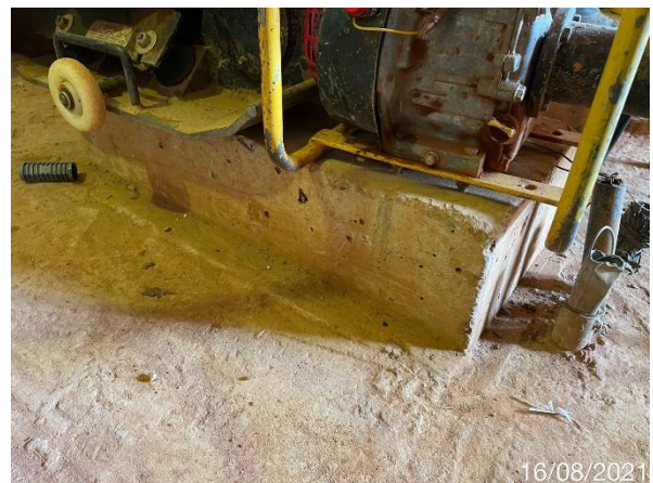
Foto 7.108: Superfícies irregulares com presença de vazios de concretagem (Data da imagem: 16/08/2021)
