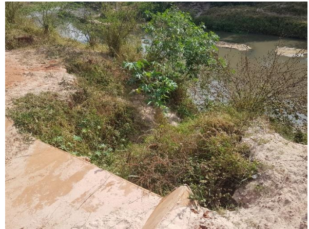
Foto 7.497: Necessário recomposição do talude na beira do rio (Data da imagem: 11/08/2021)
