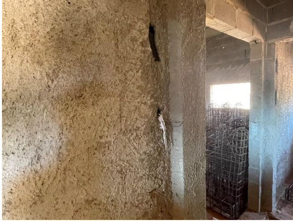
Foto 7.436: Serviços de chapisco incompletos, blocos de concreto quebrados (Data da imagem: 11/08/2021)
