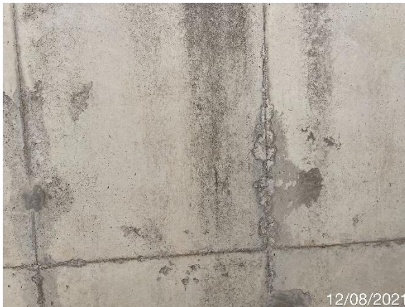
Foto 7.270: Superfície de concreto irregular com a presença de vazios de concretagem, bolhas e marcas de forma (Data da imagem: 12/08/2021)
