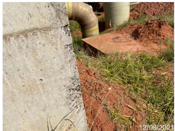
Foto 7.254: Estrutura danificada (Data da imagem: 12/08/2021)
