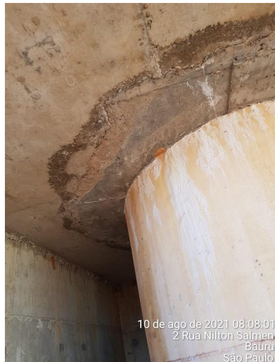
Foto 7.114: Superfície de concreto irregular, marcas das formas e vazios de concretagem (Data da imagem: 10/08/2021)
