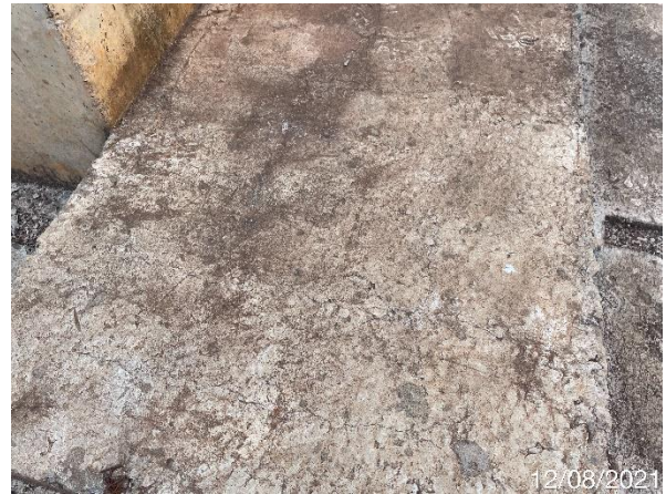
Foto 7.359: Superfície de concreto irregular com presença de fissuras (Data da imagem: 12/08/2021)
