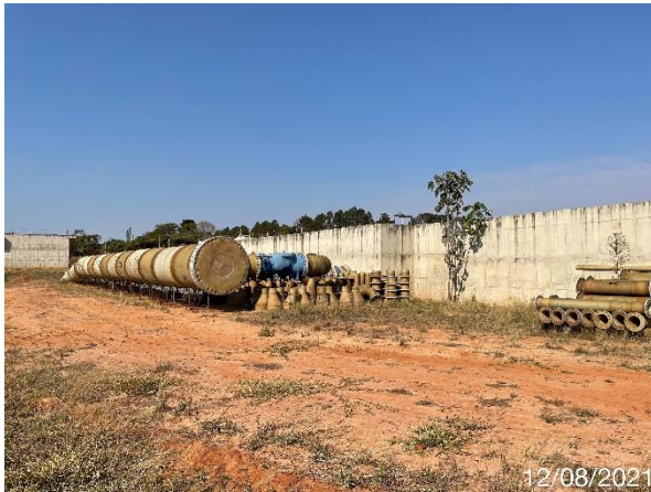
Foto 7.185: Aparência externa dos Decantadores (Data da imagem: 12/08/2021)
