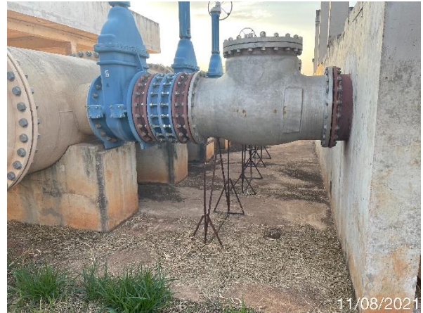
Foto 7.40: Ausência dos berços de apoio das tubulações (Data da imagem: 11/08/2021)
