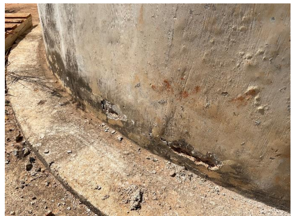
Foto 7.393: Resquícios de concreto e trincas na calçada (Data da imagem: 11/08/2021)
