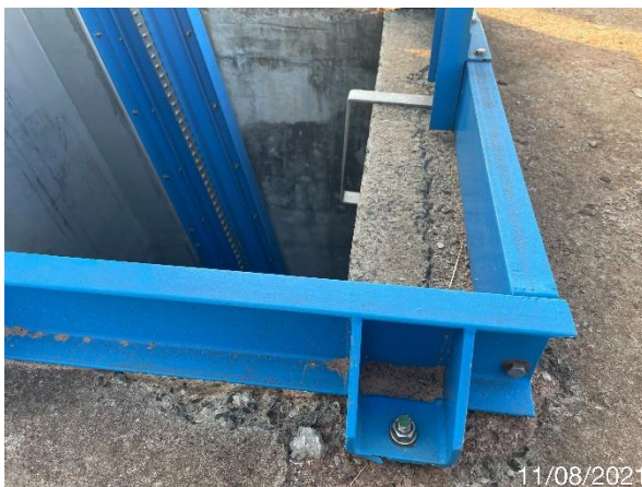
Foto 7.27: Ausência de acabamento no assentamento do equipamento e presença de trincas na região (Data da imagem: 11/08/2021)
