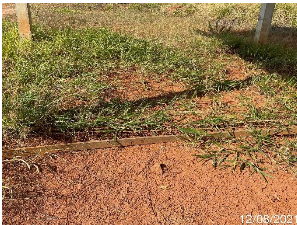
Foto 7.468: Ferragem da viga baldrame exposta sem proteção e danificadas (Data da imagem: 12/08/2021)
