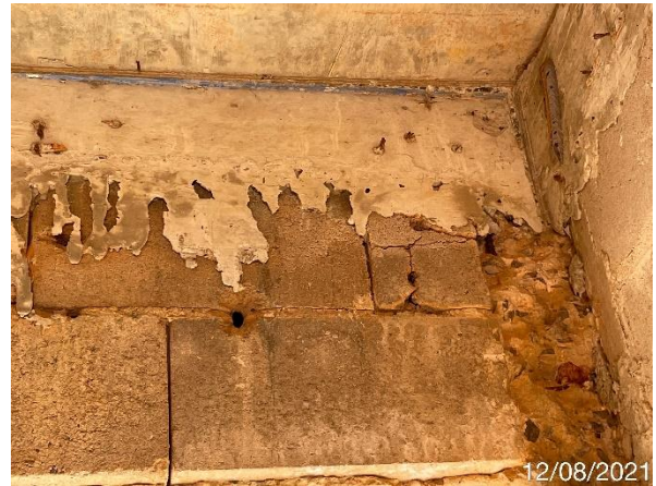
Foto 7.487: Alvenaria com blocos quebrados e danificados e ausência de chapisco (Data da imagem: 12/08/2021)
