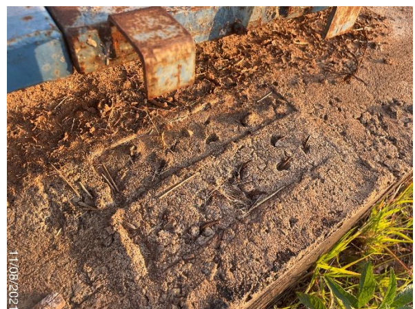
Foto 7.44: Superfície de concreto da laje irregular (Data da imagem: 11/08/2021)
