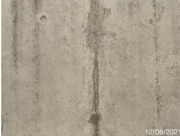
Foto 7.268: Superfície de concreto irregular com a presença de vazios de concretagem (Data da imagem: 12/08/2021)
