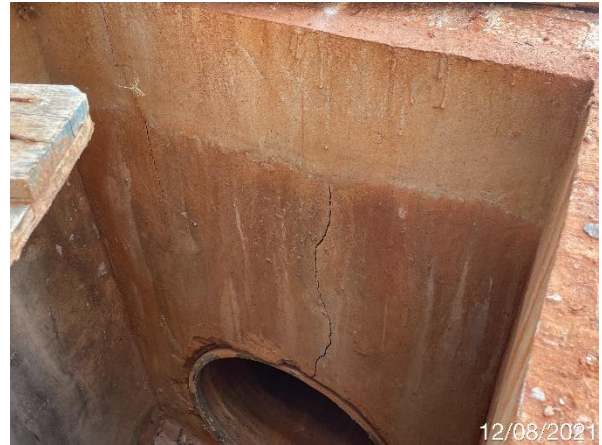
Foto 7.327: Superfície de concreto irregular, com presença de fissuras e trincas e ausência de tampa (Data da imagem: 12/08/2021)
