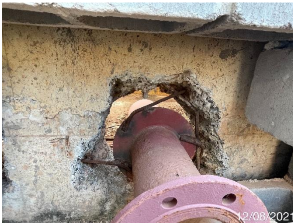
Foto 7.366: Ferragem exposta sem proteção e estrutura de concreto danificada (Data da imagem: 12/08/2021)
