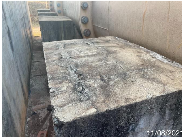
Foto 7.33: Fissuras nos berços de apoio das tubulações (Data da imagem: 11/08/2021)
