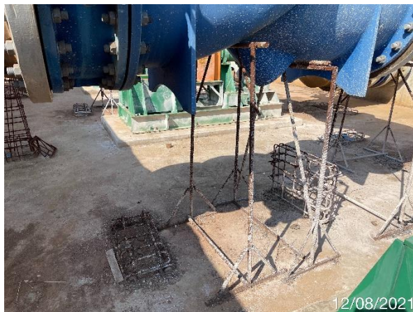
Foto 7.257: Ausência do berço de apoio da tubulação (Data da imagem: 12/08/2021)
