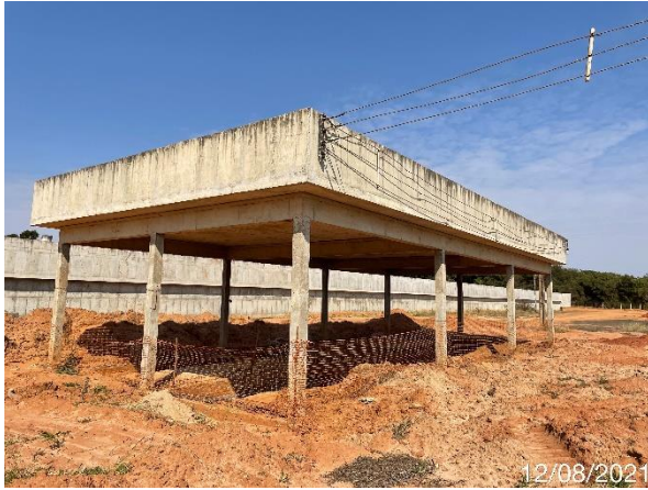
Foto 7.456: Aparência da subestação elétrica SE-05 (Data da imagem: 12/08/2021)
