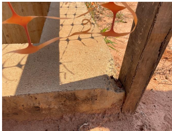
Foto 7.48: Arestas da estrutura danificadas e ferragens expostas (Data da imagem: 11/08/2021)
