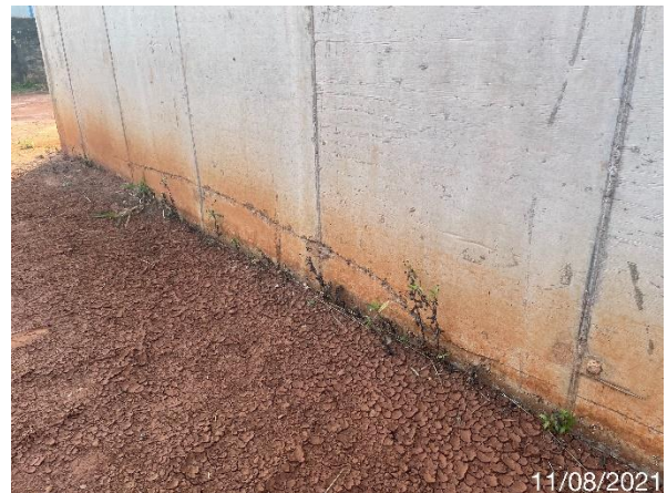
Foto 7.10: Superfície do concreto com irregularidades e marcas das formas (Data da imagem: 11/08/2021)
