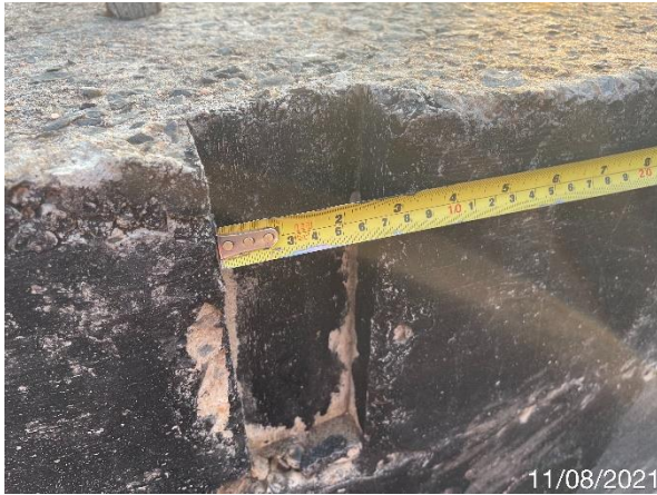
Foto 7.19: Detalhe não previsto em projeto (Data da imagem: 11/08/2021)
