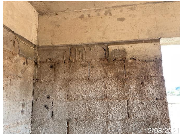
Foto 7.387: Alvenaria com blocos danificados (Data da imagem: 12/08/2021)
