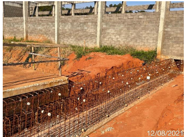
Foto 7.323: Ferragens expostas sem proteção adequada (Data da imagem: 12/08/2021)
