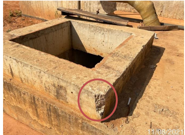
Foto 7.92: Arestas da estrutura da abertura de inspeção danificadas (Data da imagem: 11/08/2021)
